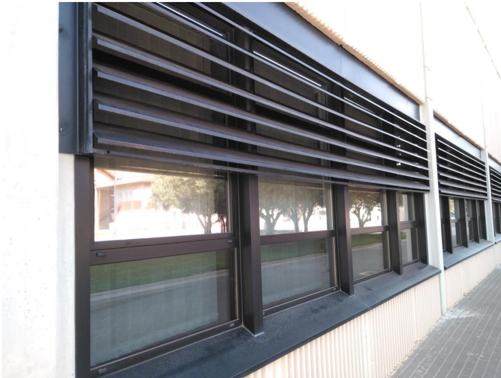
Ilustración 21. Detalle de lamas de aluminio empleadas como método de protección solar en las ventanas
