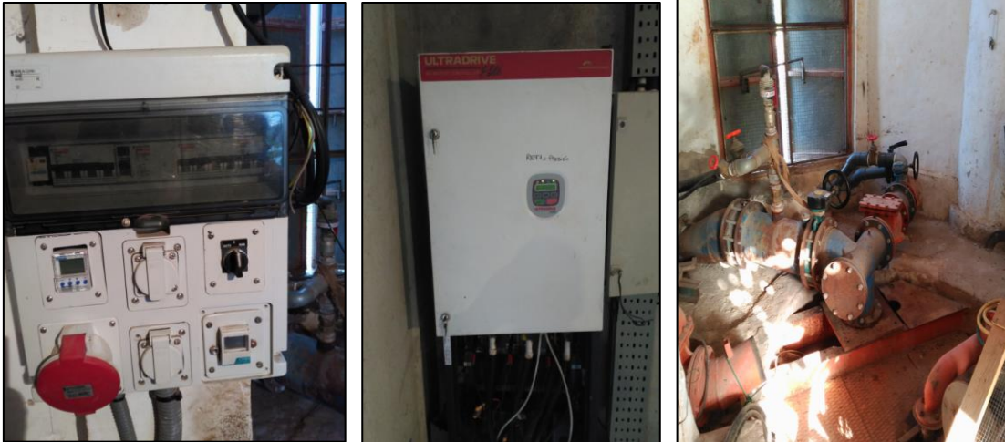
Ilustración 22. Detalle elementos eléctricos instalación Pozo Sargueta; Cuadro de mando, Variador de Frecuencia y tubería de impulsión del grupo motor-bomba sumergido.
