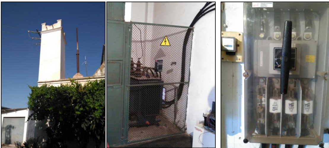
Ilustración 21. Detalle elementos eléctricos instalación del CT: Suministro aéreo, transformador y protección de BT con seccionador y fusibles.
