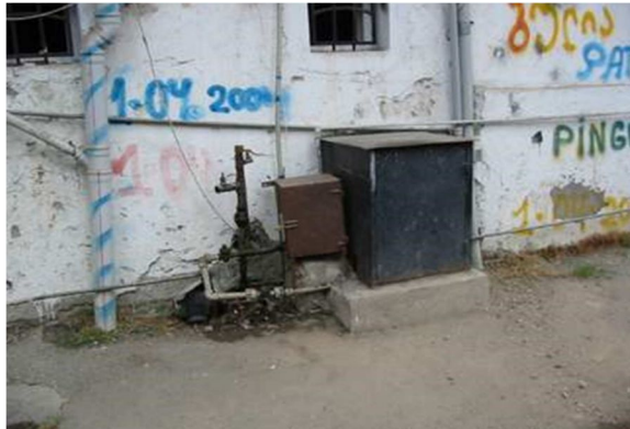
Figura 2. Microestació de Bombeig. Font TFM Jose Francisco Pons Ausina
