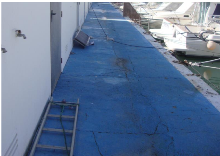
Fig.1.4d: tanto los pantalanes como las líneas de atraque se encuentran en un deficiente estado de conservación, constando el reciente desprendimiento de un fragmento de pantalán con origen en las numerosas fisuras del bloque de hormigón. Fotografía del autor.
