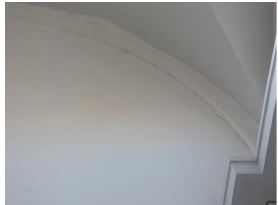
Imagen 41. Grieta interior bóveda. Fuente: fotografía propia.
