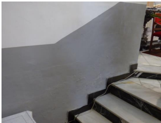
Imagen 28. Abombamientos y desconchados de pintura. Fuente: Fotografía propia.
