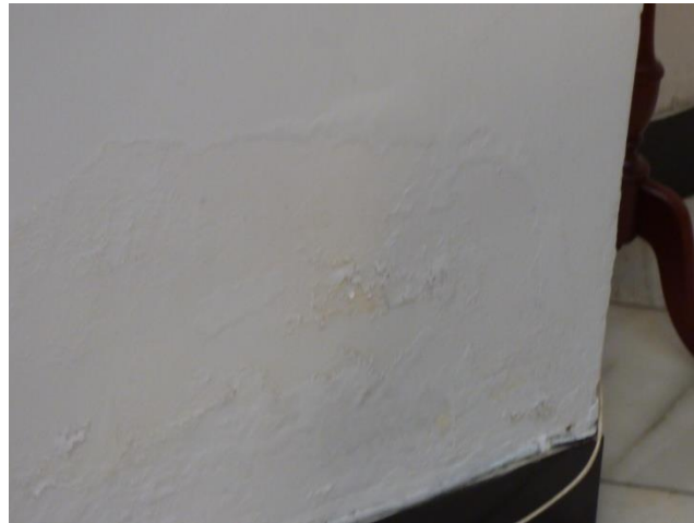
Imagen 38. Desconchado pintura altar. Fuente: fotografía propia.
