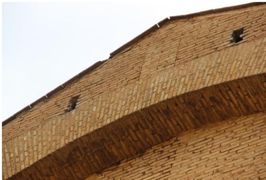
Imagen 40. Huecos zona bóveda. Fuente: Fotografía propia.
