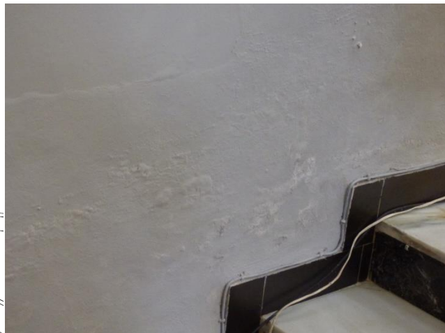
Imagen 37. Desconchado pintura escalera altar. Fuente: fotografía propia.
