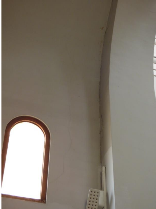
Imagen 29. Estado grieta vertical recorriendo altar mayor. Fuente: Fotografía propia.
