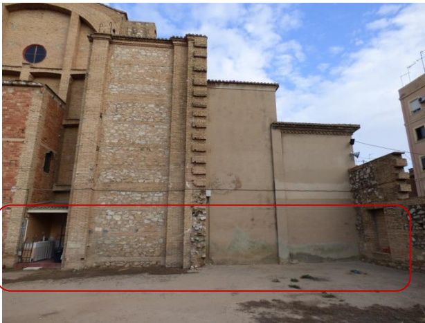
Imagen 33. Humedades en fachada trasera.
