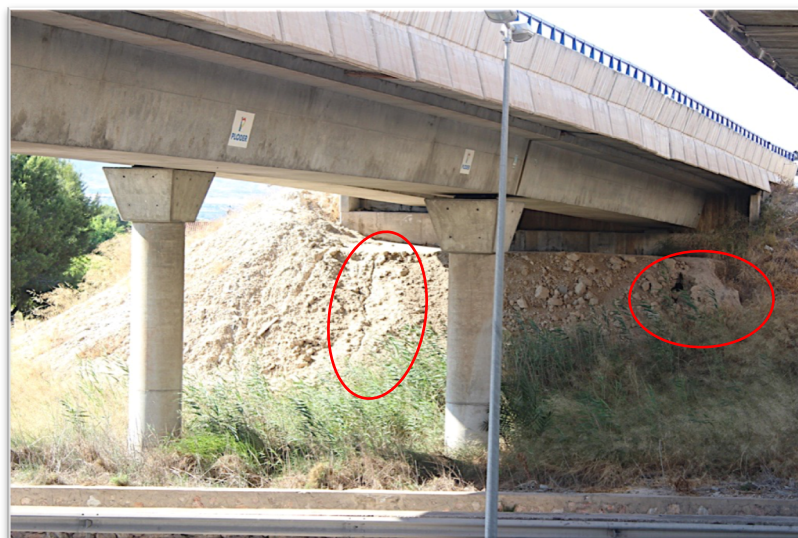
Figura 8. Detalle y grietas del estribo 1. Fuente: propia.
