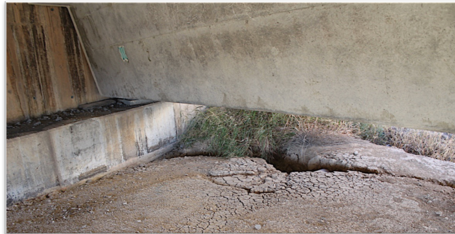
Figura 7. Agrietamiento en el estribo 1. Fuente: propia.
