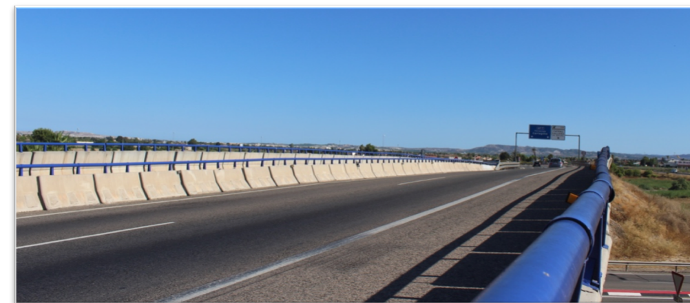
Figura 5. Detalle pavimento y cambio de rasante pronunciado. Fuente: propia.
