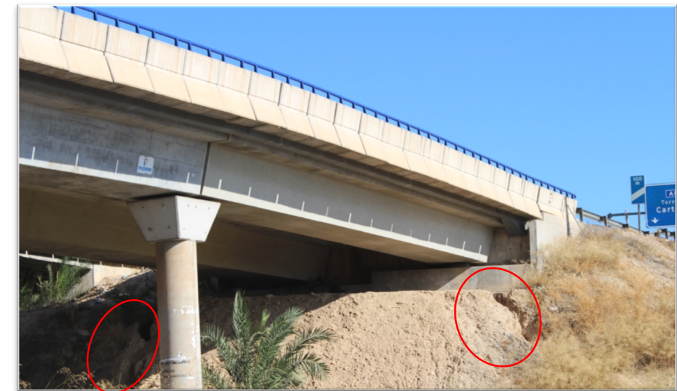
Figura 4. Detalle del estribo 2 y grietas en el terreno. Fuente: propia.
