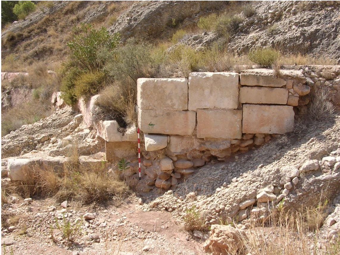
Fig. 2. Azud de La Tanca del Forat. Detalle del estribo occidental antes de la intervención.
