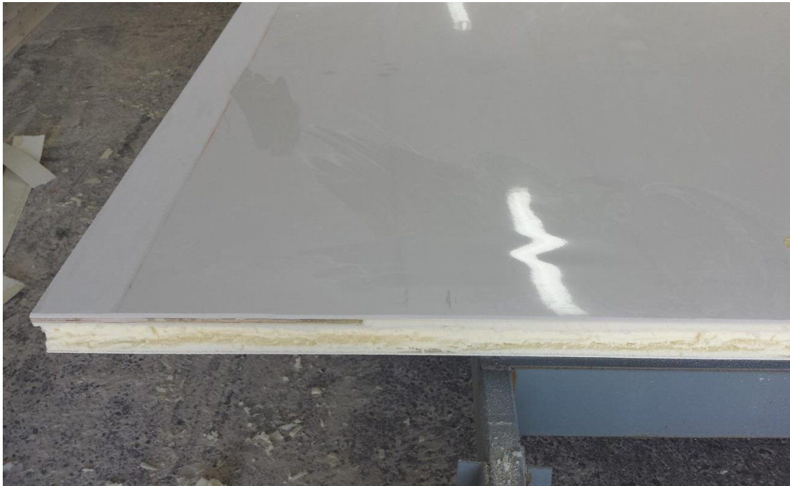
Imagen 46. Detalle de un panel a la salida de C.T. Corte de paneles.
