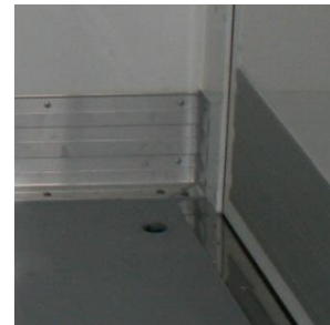
Imagen 32. Perforación en el piso de un desagüe.
