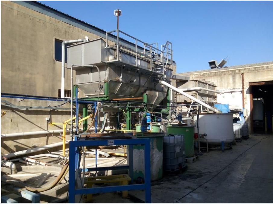
Figura 1.17 – Depuradora para el tratamiento de aguas residuales.
