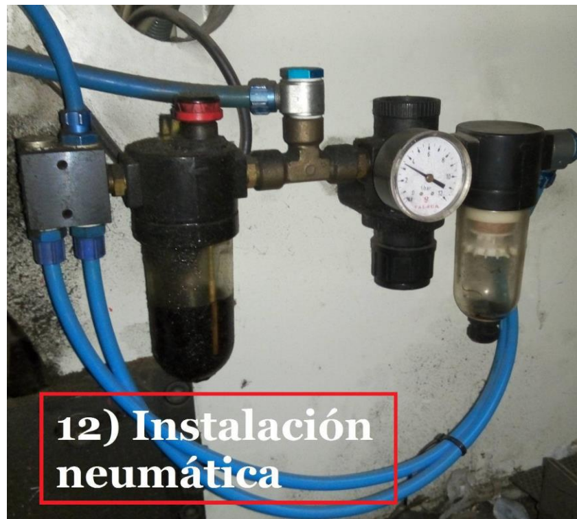
Fotografía 3. Instalación neumática (depósito de aceite)
