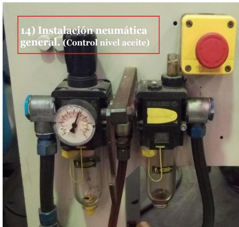
Imagen 4. Instalación neumática II (general)
