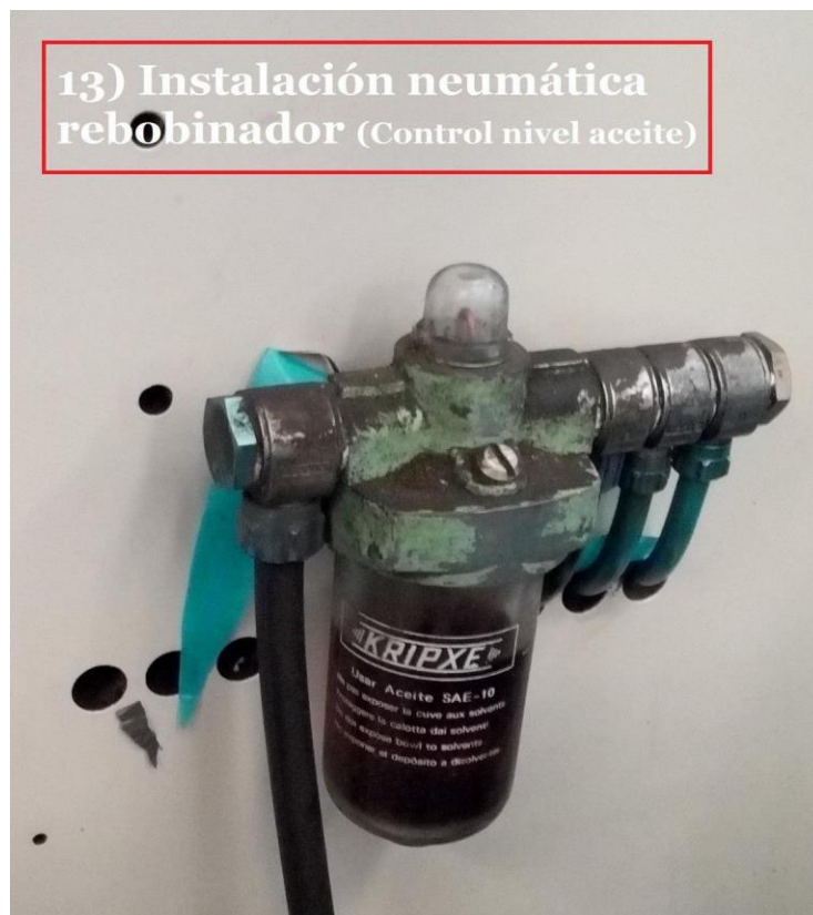
Imagen 3. Instalación neumática I (rebobinador)
