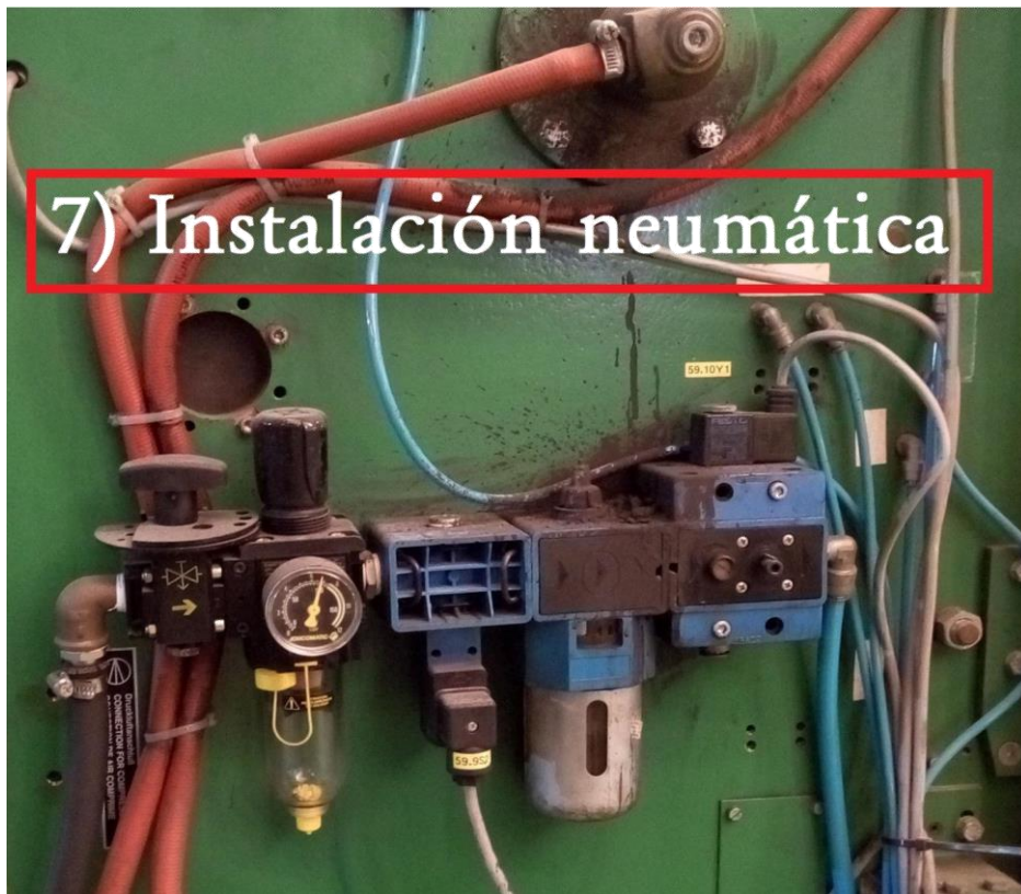
Fotografía 23. "Instalación neumática. Depósito gasificador"
