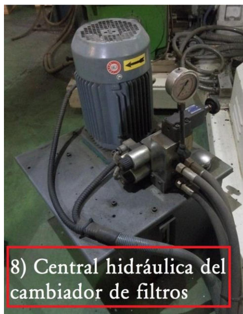
Fotografía 2. "Central hidráulica del cambiador de filtros"
