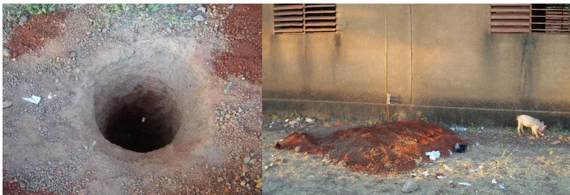
Figura 40. Toma de tierra de la instalación. Fuente: MÁRQUEZ. M.N.
