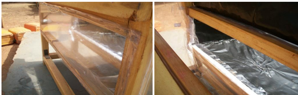
Figura 56. Detalle de la parte trasera del deshidratador, unión de colector y armario. Fuente: MÁRQUEZ. M.N.
