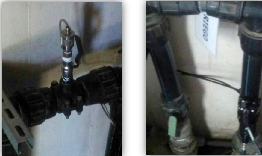
Figura 12: Transductor de presión y caudalímetro
