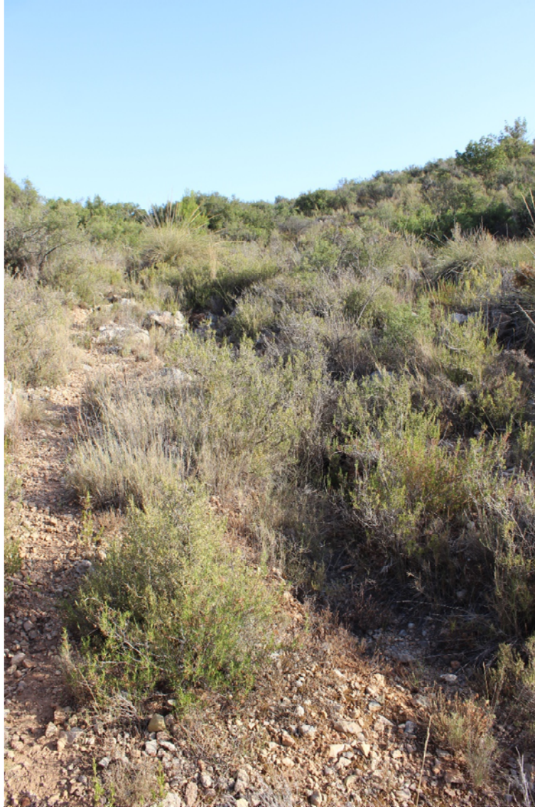
Figura 39: Camino deteriorado por acción erosiva del agua.
