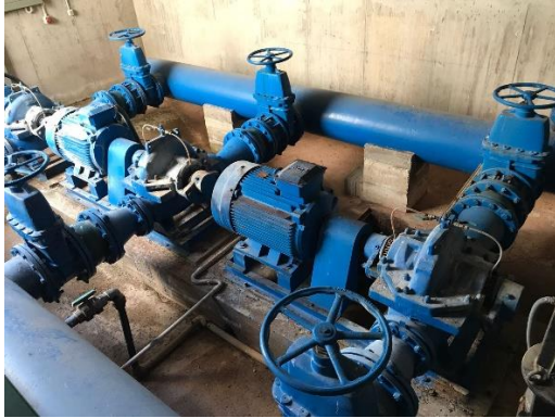
Figura 6. Impulsión de las 3 bombas horizontales en paralelo.
