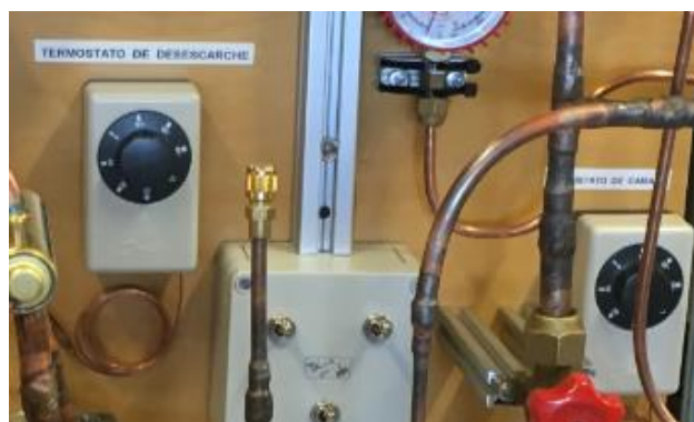
Figura 4.20. Situación de los termostatos en el tablero de sensores.
