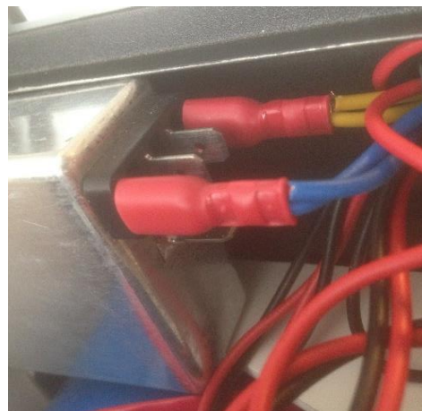
Figura 48. Fotografía del resultado final de los conectores del filtro IEC con los cables.
