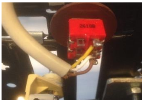
Figura 54. Imagen del resultado final de la conexión entre el cable procedente de la placa de control y el interruptor de programación-ejecución.
