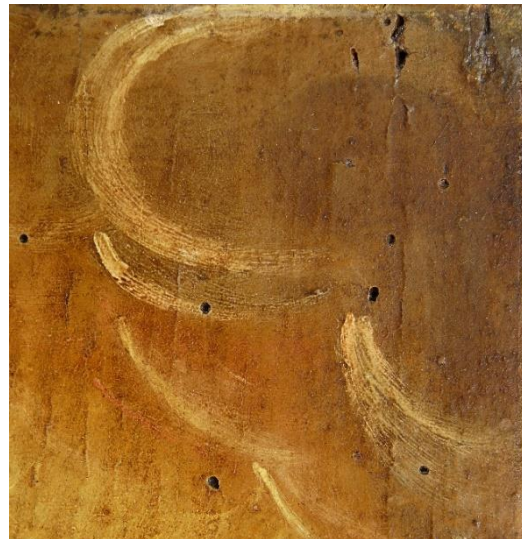
Fig. 125. Detalle de las galerías de insectos xilófagos
