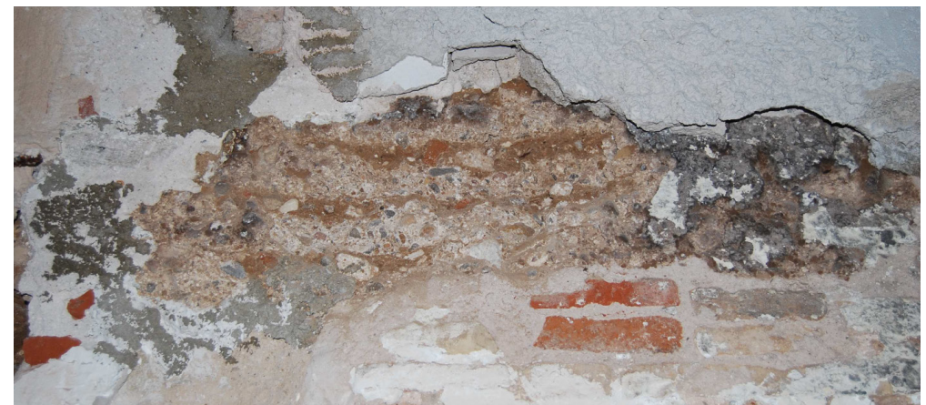
Detalle de las lenguas del tapial donde existe una pérdida de la costra de hormigón
