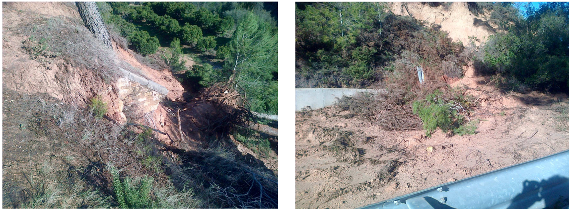
Figura 2. Situación posterior al deslizamiento del talud sobre la CV-615.
