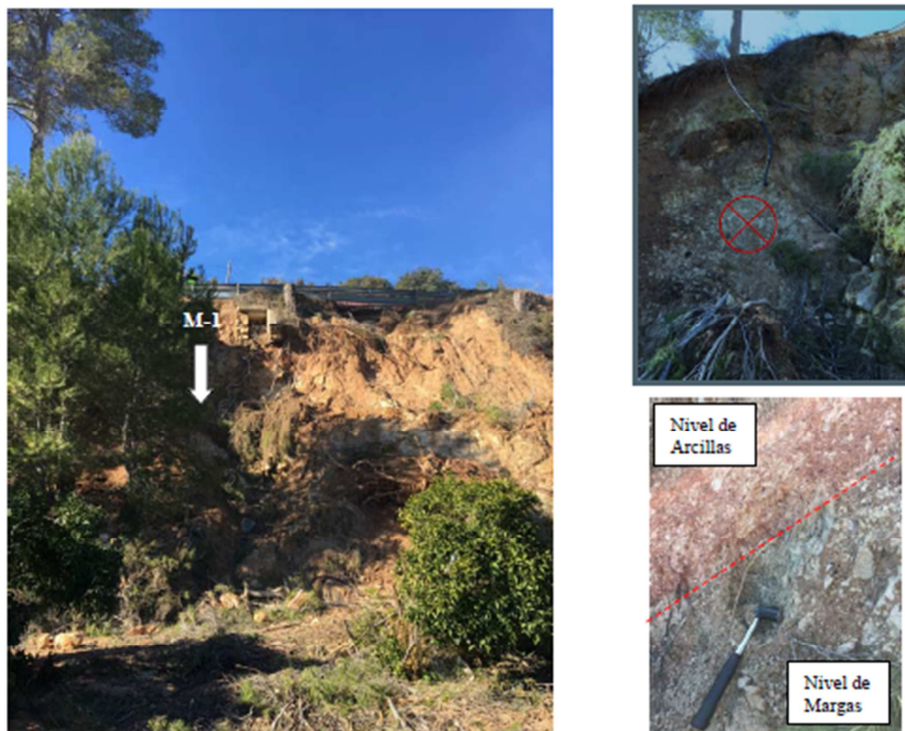
Figura 15. Localización de la toma de muestra N o 1: Margas Tap. Talud de la ladera del margen izquierdo CV-615 PK 4+990
