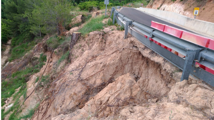
Figura 3. Situación del deslizamiento del talud bajo la CV-615.
