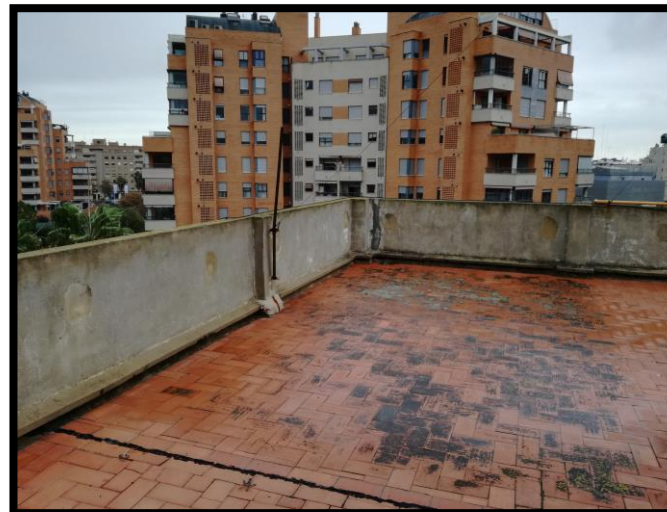
Manchas humedad en pavimento azotea
