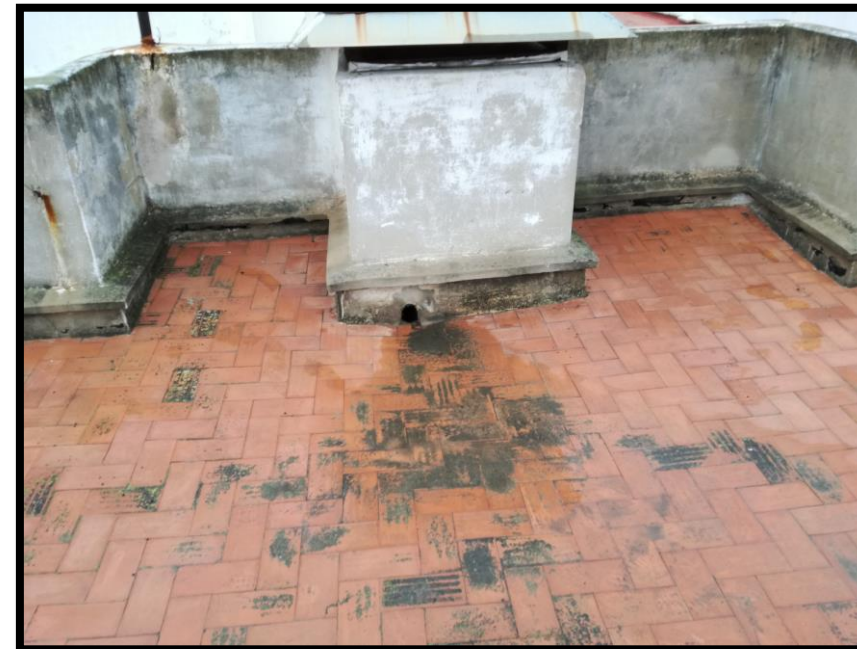
Acumulación de agua en cubierta
