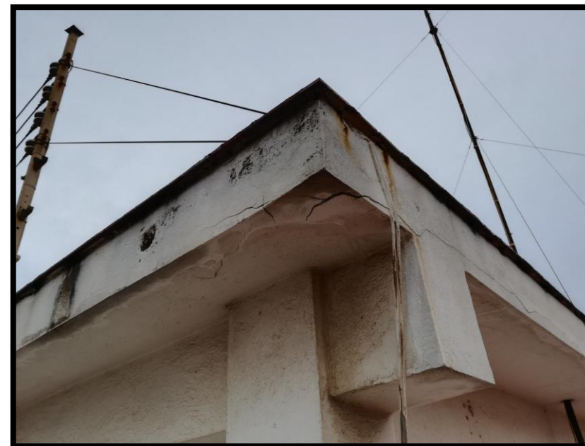
Grietas en forjado de casetón
