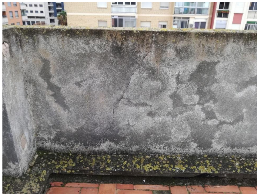
Ilustración 40. Grieta en antepecho. Propio
