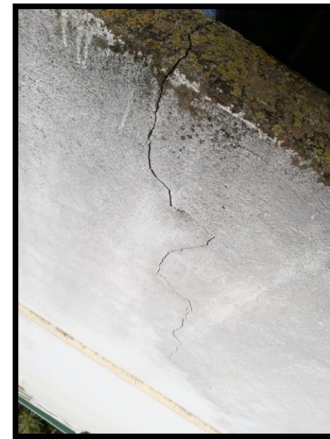
Grieta en paramento cara exterior
