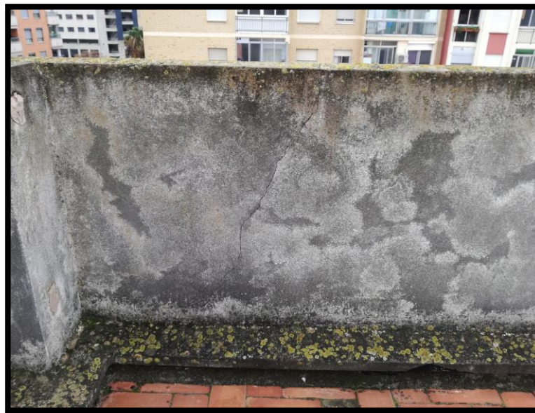
Grieta en paramento cara interior
