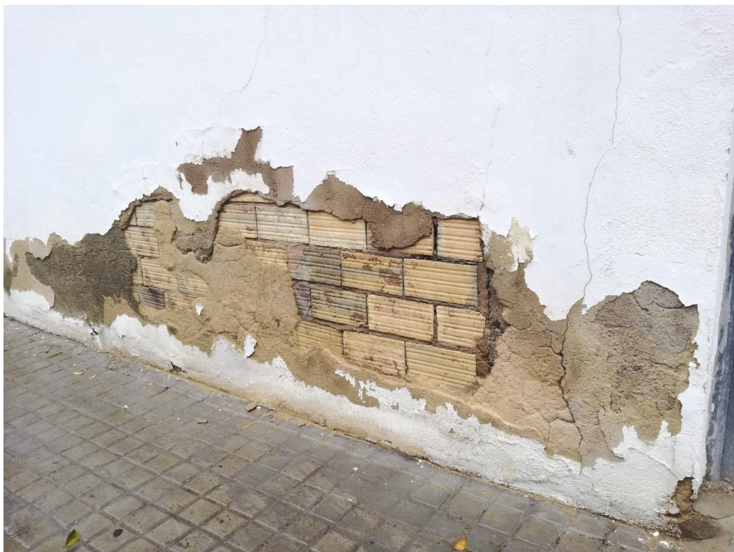
Ilustración 36. Desprendimiento enfoscado en fachada posterior.
