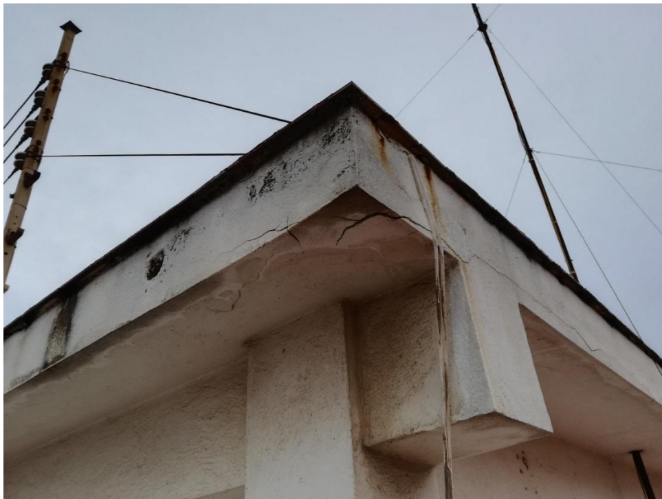
Ilustración 33. Grietas en forjado de casetón.
