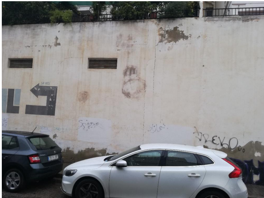
Ilustración 41. Humedades en fachada posterior. Propio.
