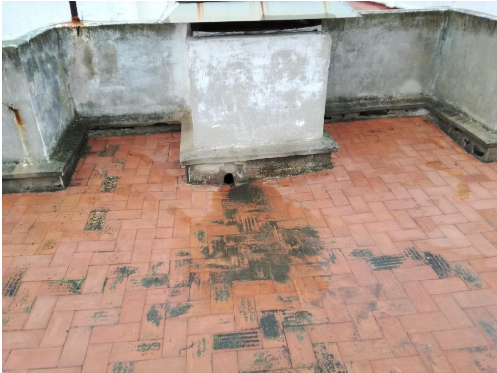
Ilustración 37. Acumulación de agua en azotea.
