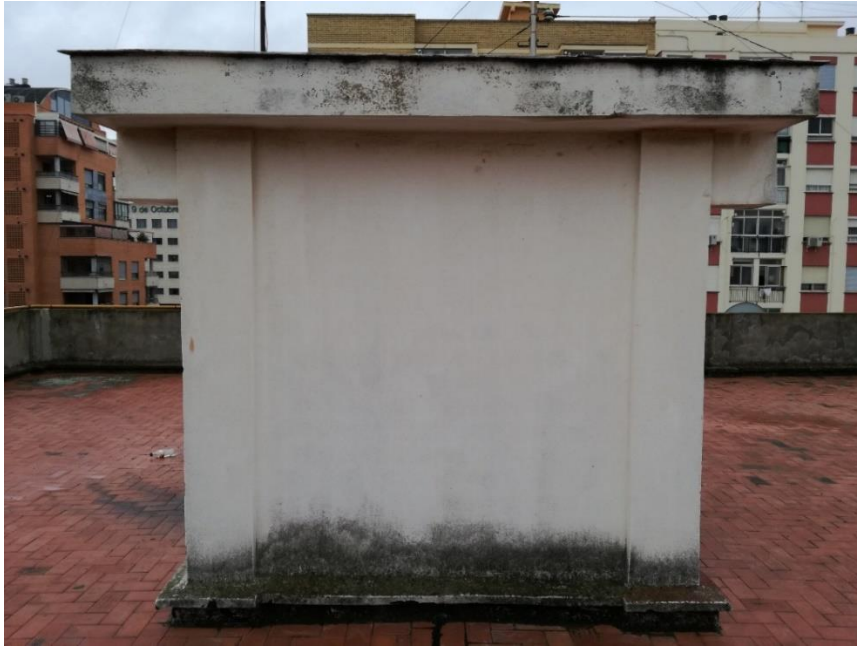
Ilustración 39. Manchas de humedad en el casetón. Propio
