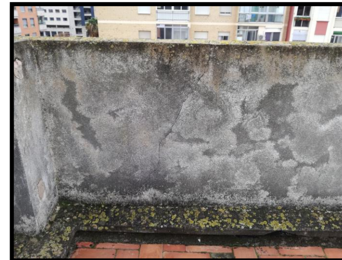
Hongos en antepecho azotea
