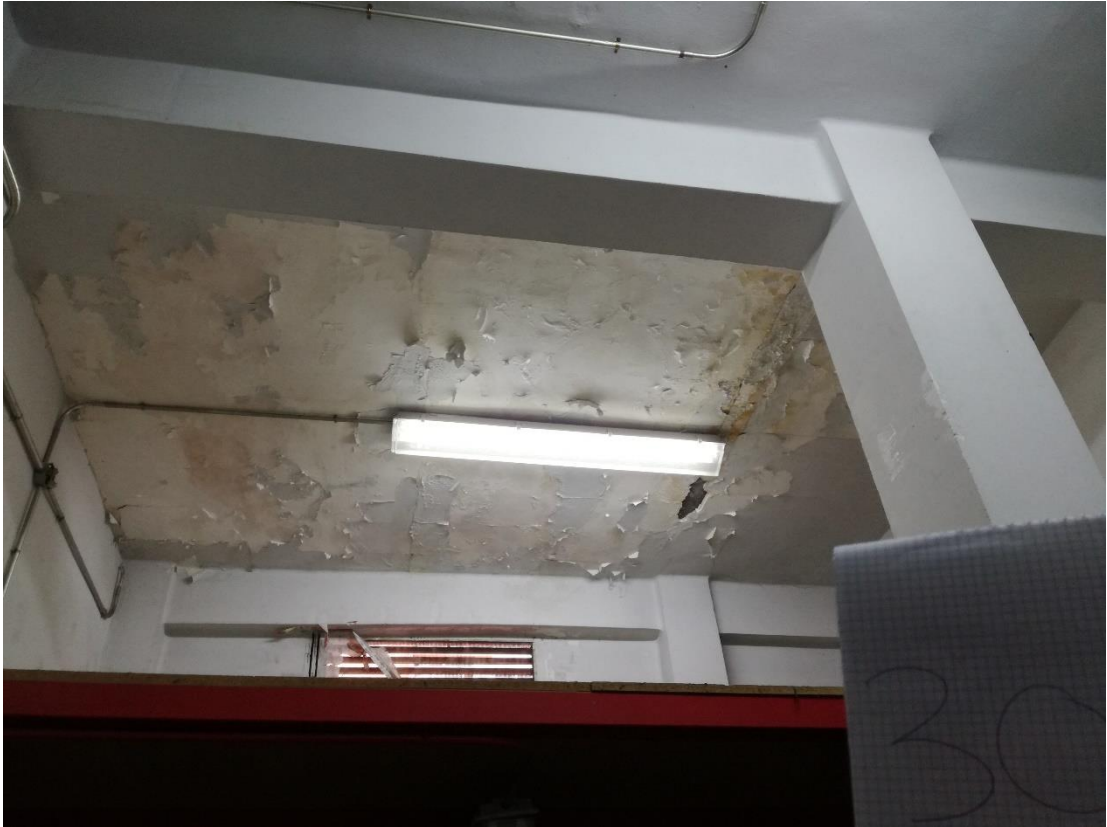
Ilustración 35. Desprendimiento pintura en techos
