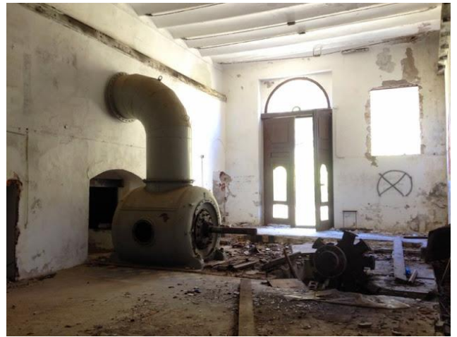
Fotografía 34: Sala de turbinas, despues de ser robada. Fuente: (Cervera et al., 2010)
