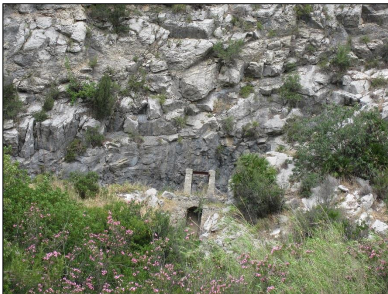
Fotografía 41. Compuerta de regulación del caudal. Tomada 07-2-2015
