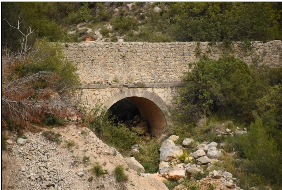
Fotografía 66. Puente de la ruta verde del Serpis, aun está en funcionamiento pero necesita mantenimiento. Está ubicado aguas abajo del azud l’Infern. Tomada 08-05-2017
