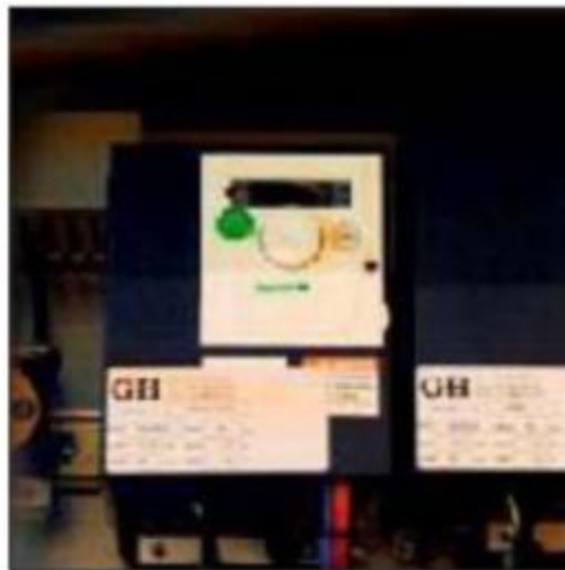
Un variador de frecuencia para la traslación del puente.
