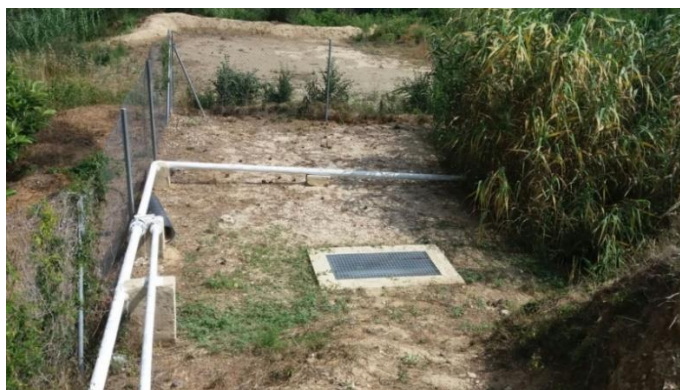
Figura 4.22. Salida del HAFSSV (Arqueta A5). Fuente: Elaboración propia (junio 2017).
