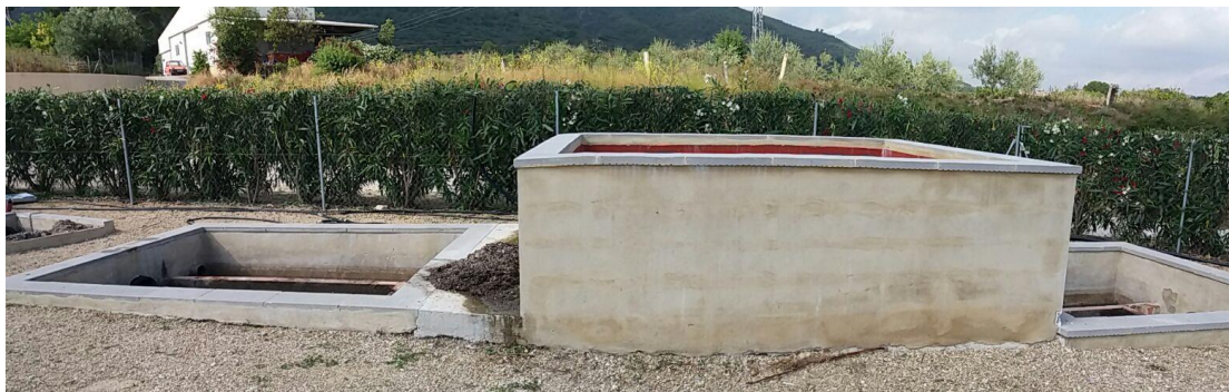
Figura 4.11. De arriba a abajo y de izquierda a derecha; tanque Imhoff 1, tanque Imhoff 2 y tratamiento primario en conjunto. Fuente: Elaboración propia (noviembre 2016 y mayo 2017).
