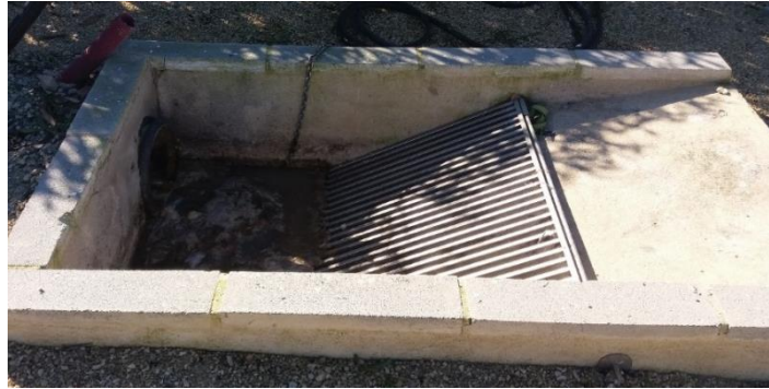
Figura 4.10. Canal de desbaste. Fuente: Elaboración propia (noviembre de 2016).
