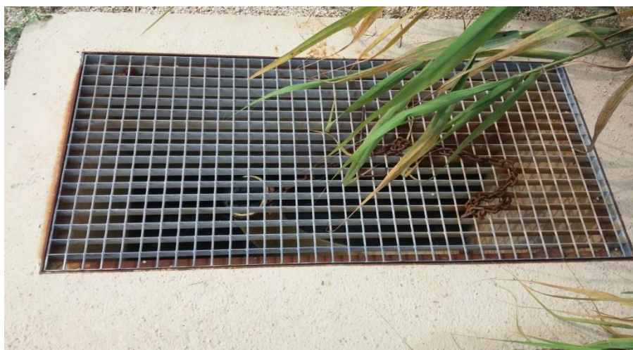
Figura 4.20. Arqueta A2, idéntica a A3, a la salida de las celdas del HAFSSH. Fuente: Elaboración propia (junio 2017).
