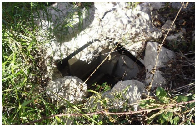
Figura 4.17. Pozo de registro y aliviadero. Fuente: Elaboración propia (noviembre 2016) .
