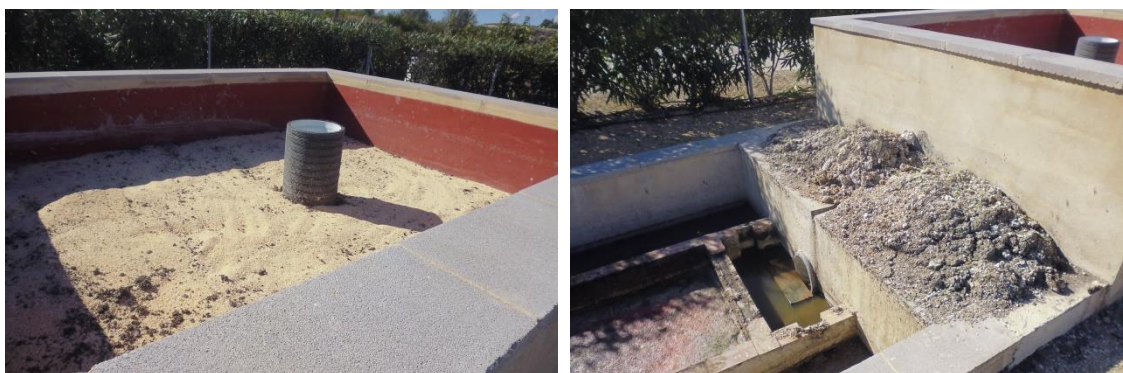
Figura 4.12. De izquierda a derecha, área de secado de los fangos extraídos de los tanques Imhoff y losa en la que se depositan los flotantes para su secado. Fuente: Elaboración propia (octubre 2016).
