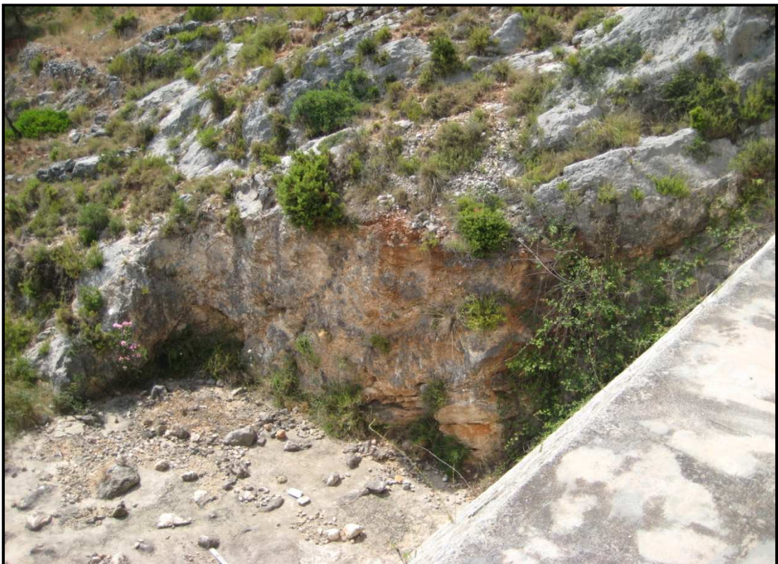
Foto 4 Detalle de la roca madre sobre encachado. Barranco Basiets.
