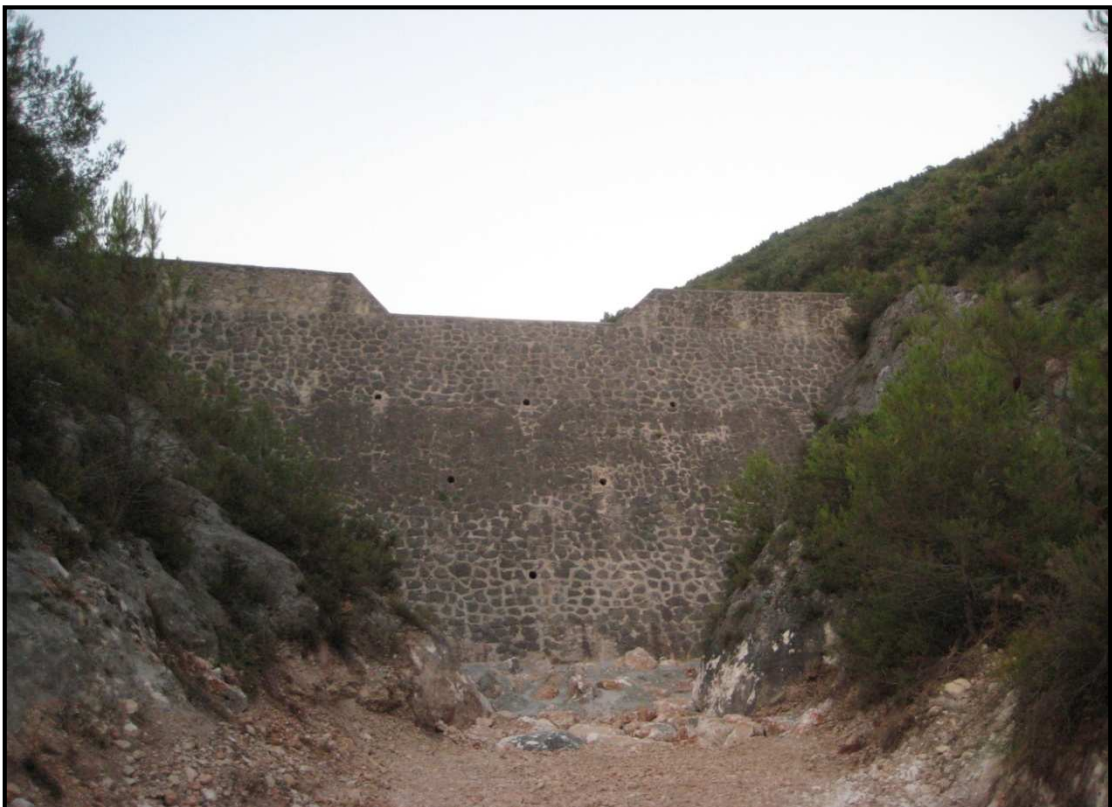
Foto 6. Aguas abajo del dique en barranco de les Foyes.
