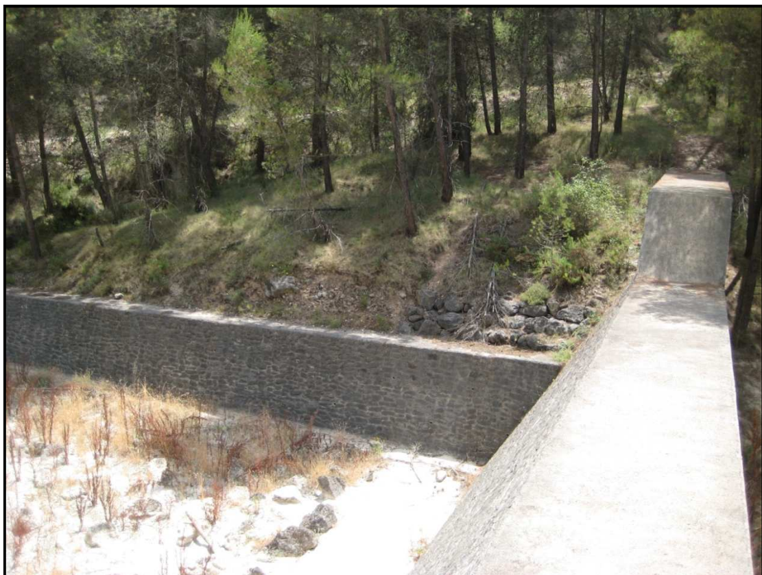
Foto 24. Detalle de la protección lateral del cauce. Río Molinar.
