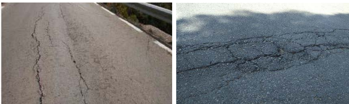
Fig. 27 Grietas (izquierda) y raíces (derecha) en la red (Corb, 2017).
