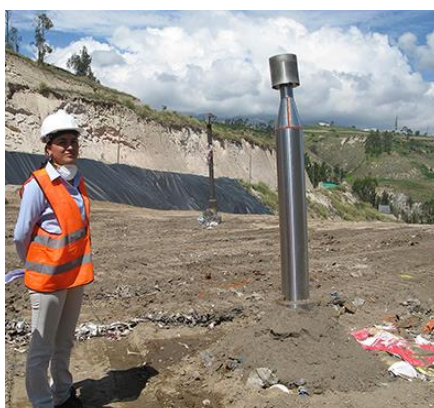
Foto N° 4. Quemadores de biogás
