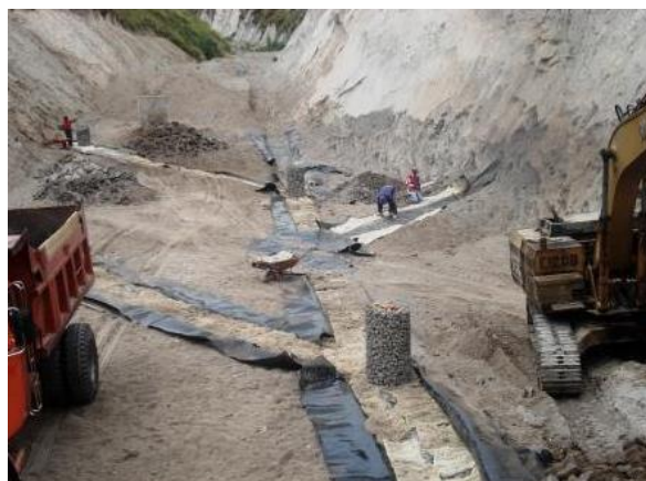
Foto N° 3. Tubería de Recolección de lixiviados
