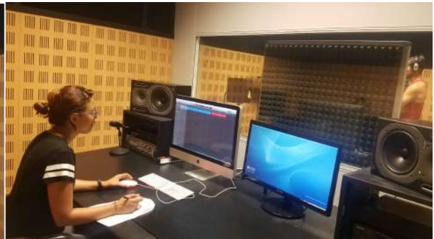
Figura 5. Control técnico del Estudio de grabación del Campus de Gandia
