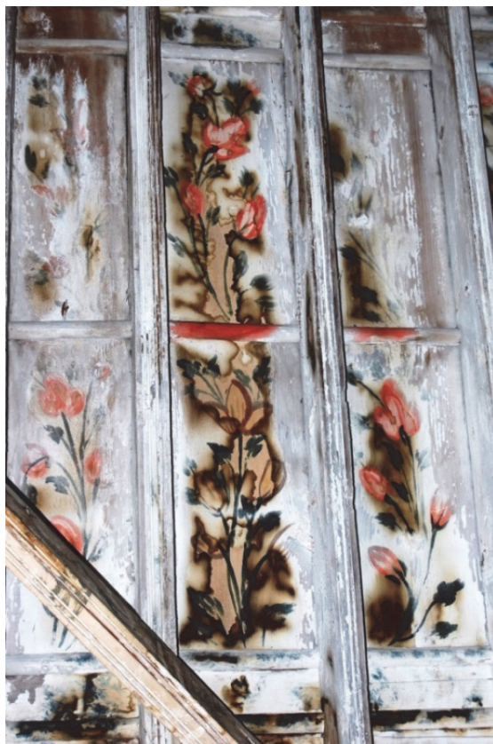
Figura 4.11. Daños producidos por las filtraciones del agua de lluvia y aparición de manchas de humedad. Techumbre del coro de la Iglesia de la Orden Tercera de San Francisco de Asís, Santa Cruz de Tenerife (Islas Canarias). Juan Hernández Delgado (1760 aprox.).
