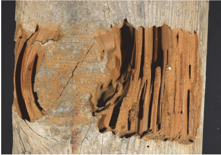
Figura 4.6 y 4.7. Isóptero o termita (en este caso, obrera). Tamaño y aspecto de sus galerías y daño de la madera.
