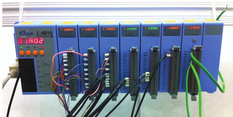
Figura 3.7: Fotografía del módulo de adquisición de datos
