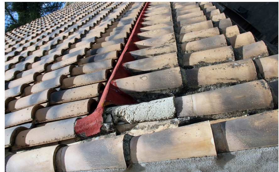
Img. 210: Rotura puntual de tejas. Estado actual.
