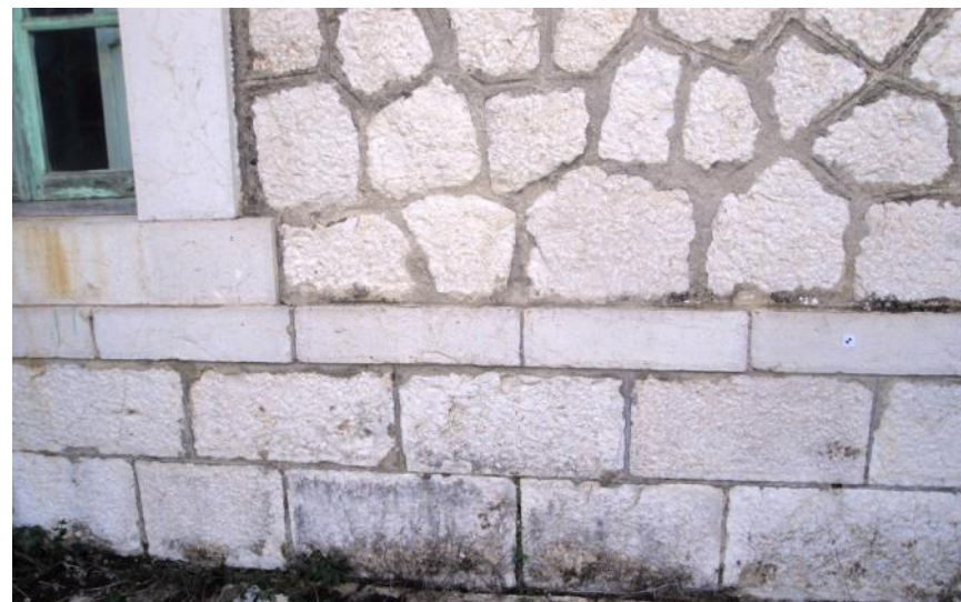
Img. 300: Humedad por capilaridad. Descomposición del mortero entre juntas y erosión.
