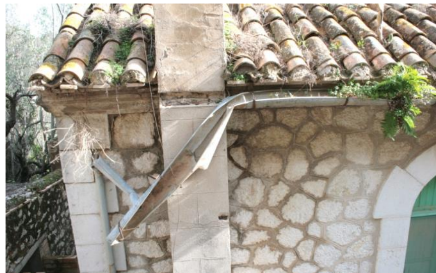
Img. 294: Rotura de canalón y bajante. Presencia de agentes bióticos.
