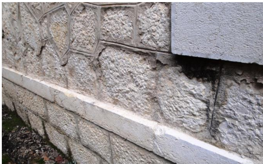
Img. 301: Humedad por capilaridad. Descomposición de morteros y erosión.
