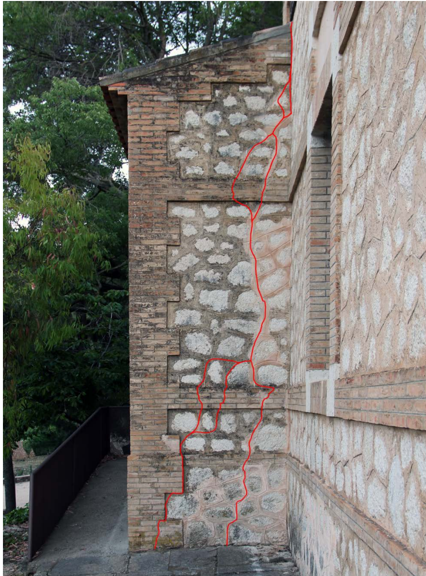
Img. 205: Grietas y fisuras. Mapeado de lesiones. Estado actual.
