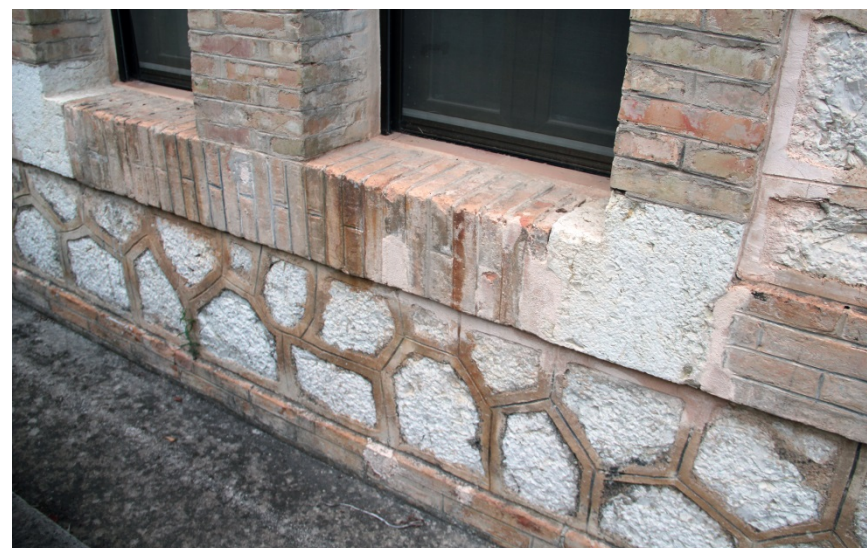
Img. 208: Manchas en zona de alféizar ventana. Escorrentía. Estado actual.
