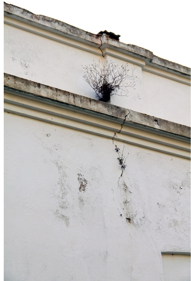
Img. 238: Grieta y rotura del arco. Asentamiento diferencial fachada principal.
