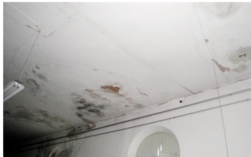
Img. 288: Infiltraciones en cubierta inclinada y falsos techos. Vertiente Este. Estado actual.
