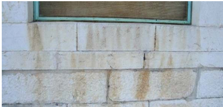
Img. 297: Manchas por arrastre de óxido de mosquitera metálica en paramento.
