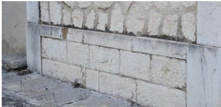
Img. 298: Manchas por arrastre de partículas y lavado de la piedra.
