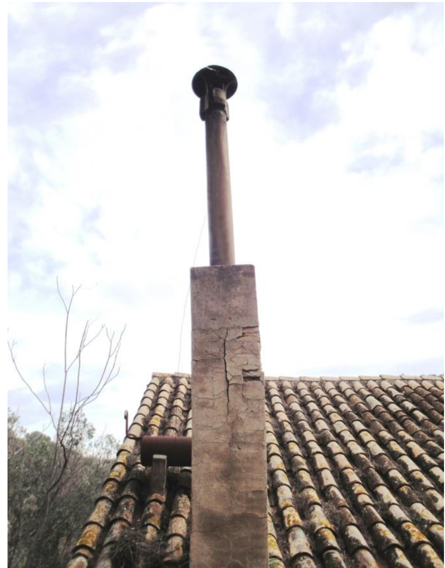
Img. 308: Patología chimenea, rotura, desplome y peligro de colapso.
