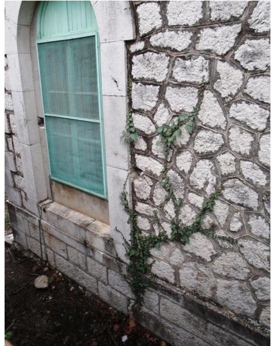
Img. 304: Ataque por agentes orgánicos generalizada en juntas, propia piedra y presencia de plantas. Orientación Norte
