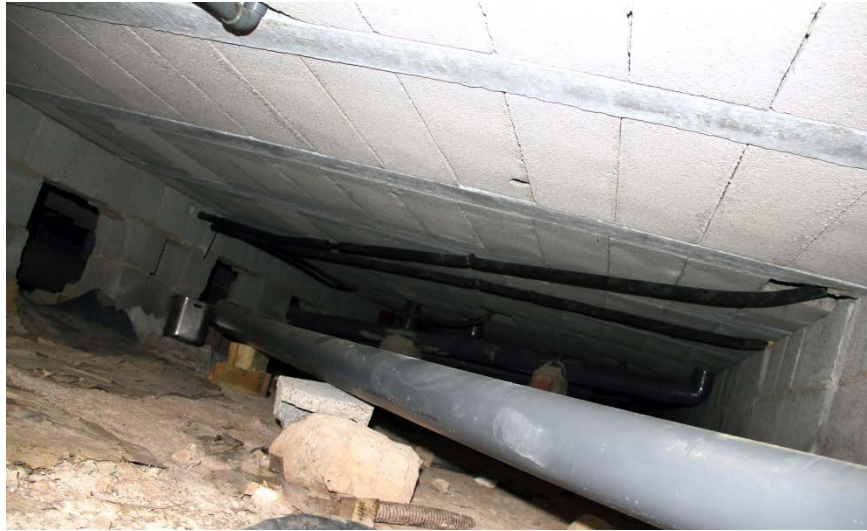
Img. 197: Forjado sanitario. Estado actual. Instalaciones de calefacción y saneamiento. Presencia de suciedad y escombros.
