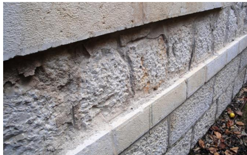
Img. 302: Humedad por capilaridad. Descomposición del mortero entre juntas y erosión.
