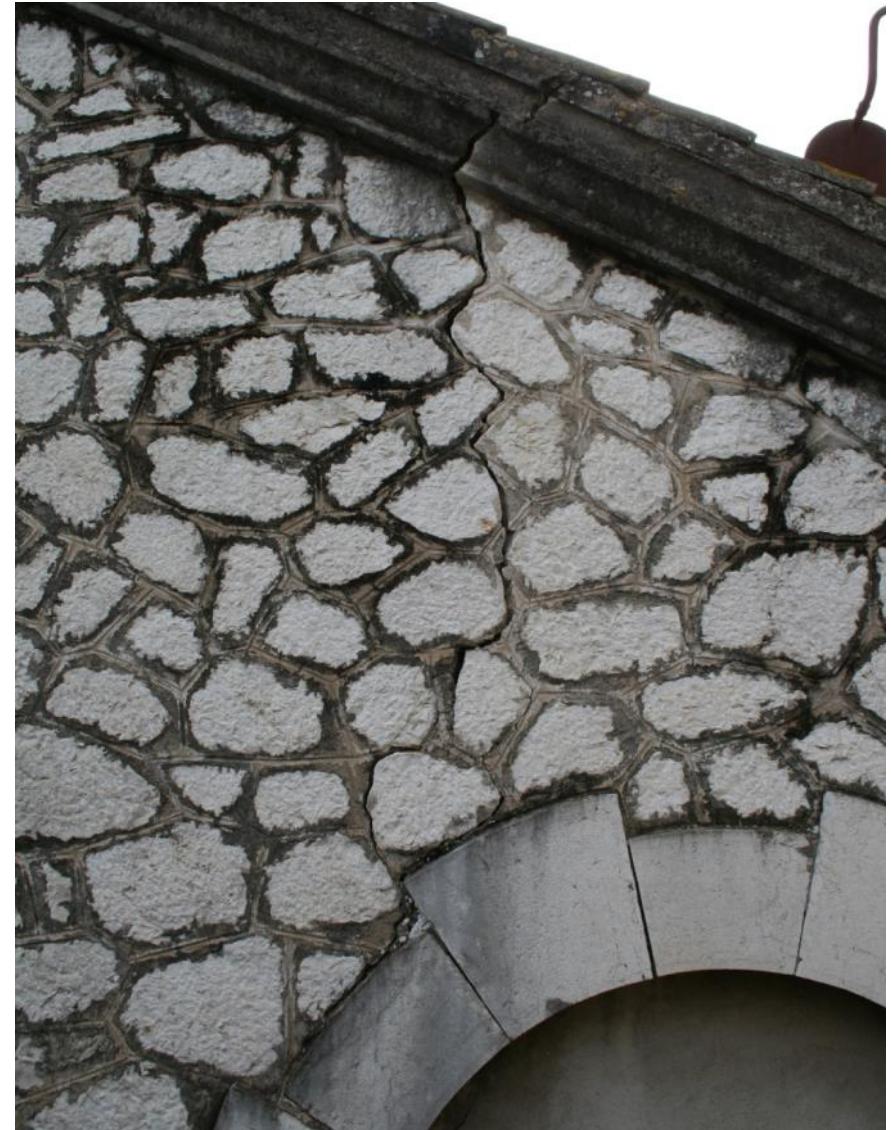
Img. 287: Grieta en fachada posterior. Asentamiento diferencial en el muro Norte.
