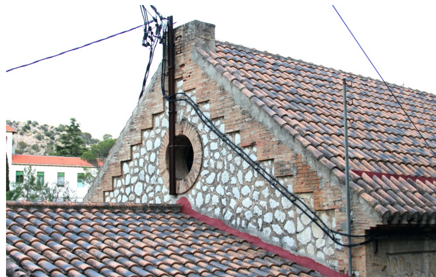
Img. 212: Elementos impropios. Postes y cableados. Estado actual.
