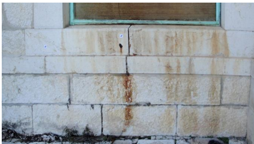
Img. 309: Manchas por escorrentía de óxido de la mosquitera sobre el paramento.
