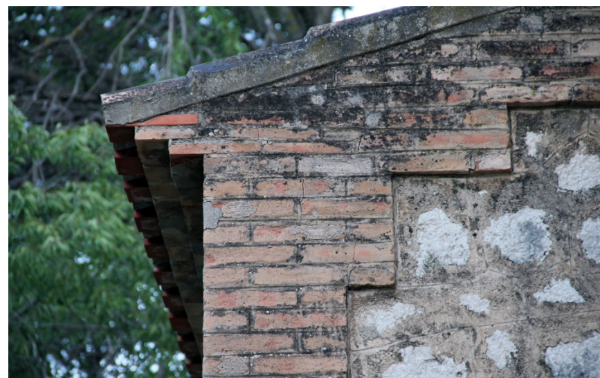
Img. 207: Escorrentía y agentes bióticos. Punto singular, solución deficiente. Estado actual
