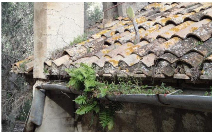
Img. 295: Colapso del canalón. Plantas y agentes bióticos.
