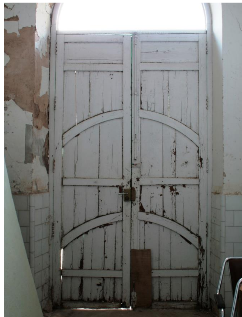
Img. 310: Portón de acceso principal. Deterioro y pudrición de la madera.
