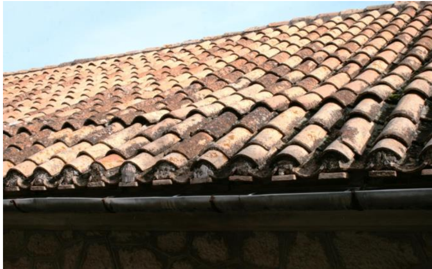
Img. 290: Asentamiento diferencial de la cubierta. Desplazamiento de cobertura de teja.
