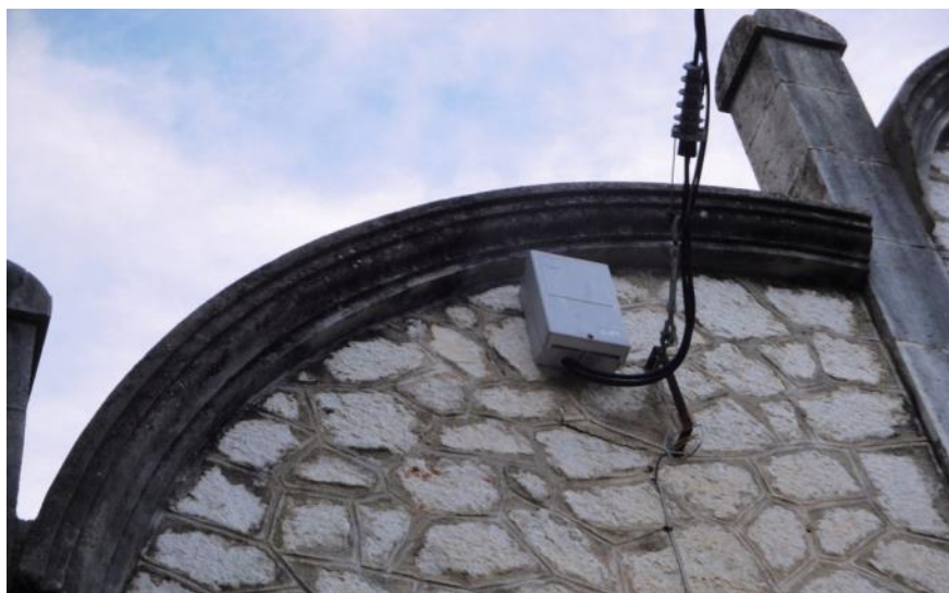
Img. 306: Instalaciones. Elementos y anclajes impropios.
