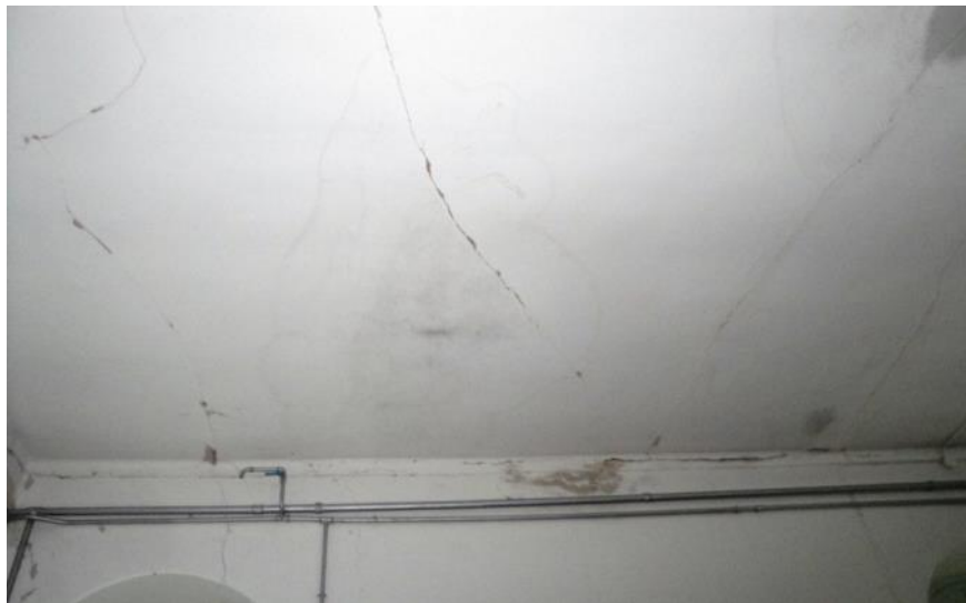
Img. 292: Infiltraciones y rotura falsos techos sala principal. Estado actual.
