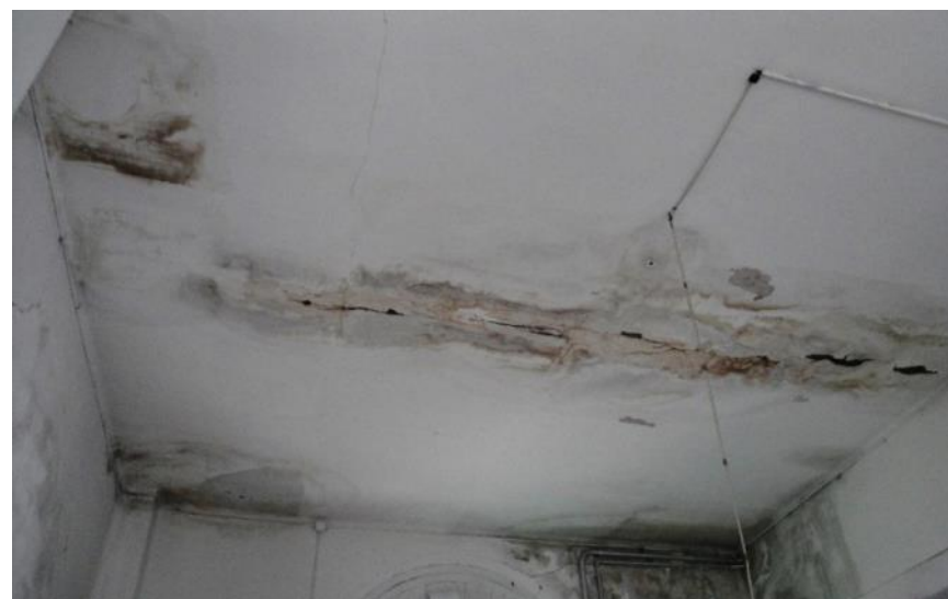
Img. 289: Infiltración cubierta plana. Lesiones en falso techo de cañizo.
