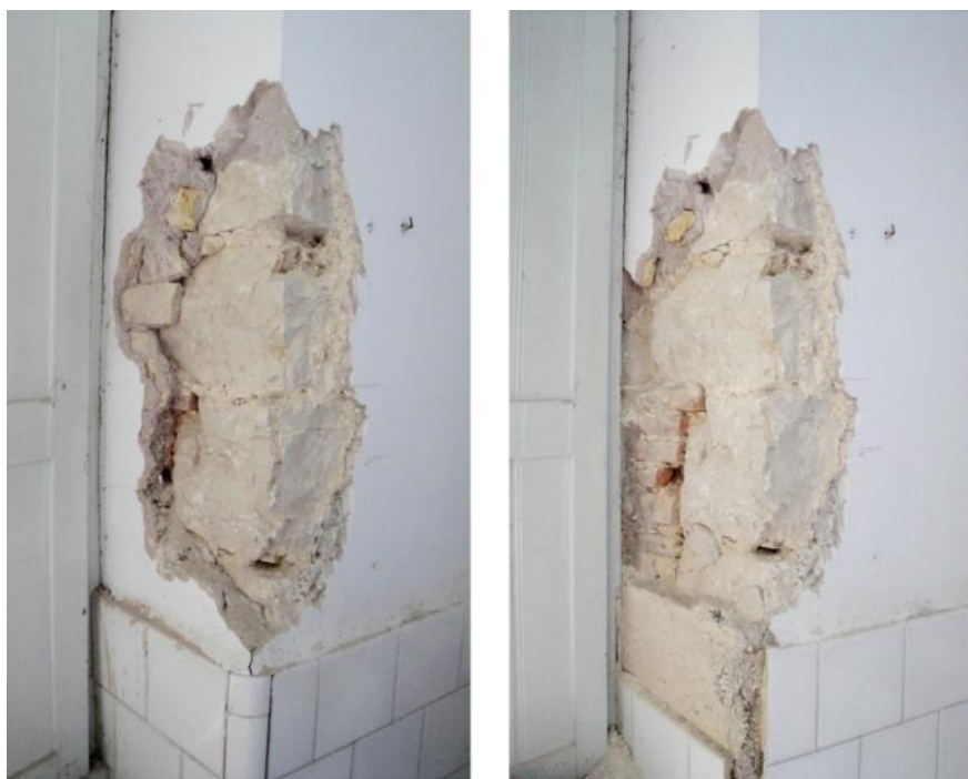
Img. 263: Cata revestimiento interior. Zona jamba ventana. Localización revestimientos de acabado preexistentes y relleno cerámico en huecos abocinados.
