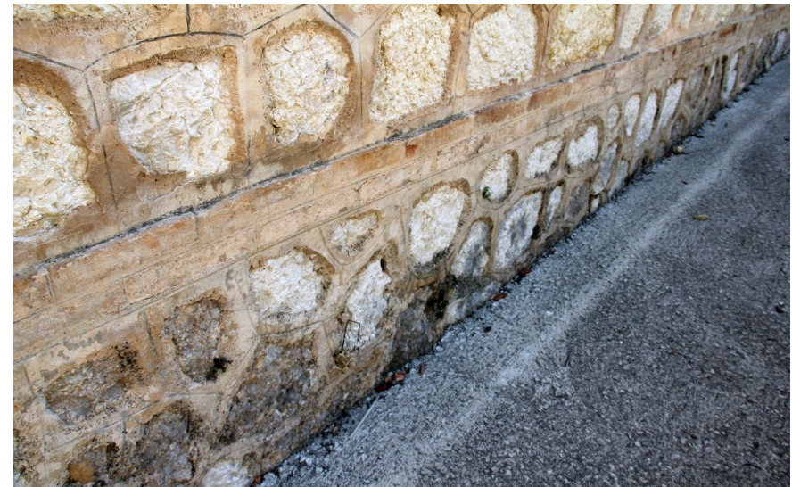
Img. 209: Humedad por capilaridad en muros. Fachada este. Estado actual.
