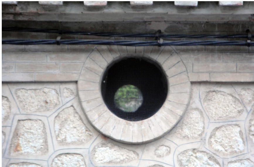
Img. 202: Óculo cerámico para ventilación intradós de cubierta. Alzados laterales. Estado actual.
