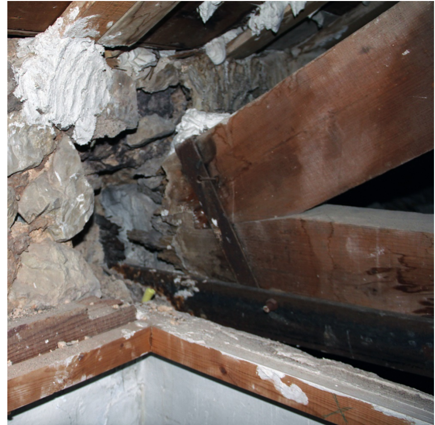
Img. 240: Empotramiento de Cercha de madera en Muro de carga. Pudrición.
