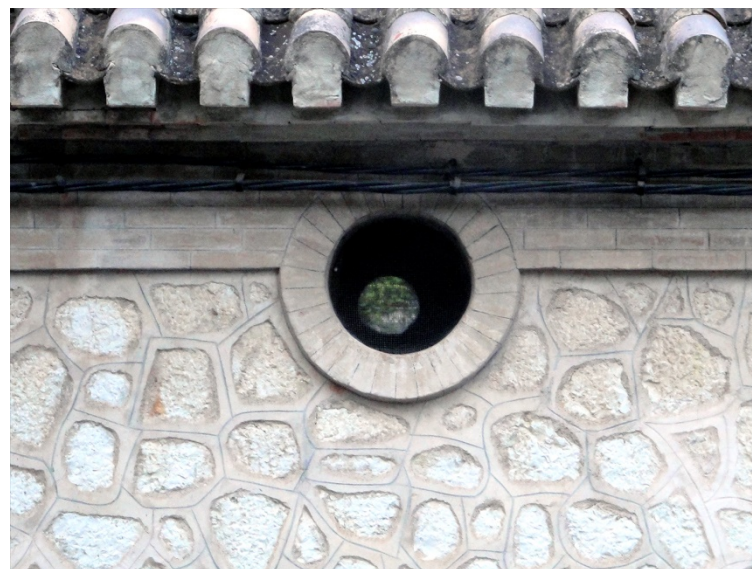
Img. 322: Muro de mampostería. Fingido de juntas fábrica ladrillo y piedra.
