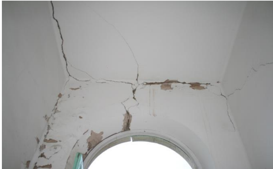
Img. 285: Grietas por desplazamiento horizontal del muro y asentamiento diferencial.
