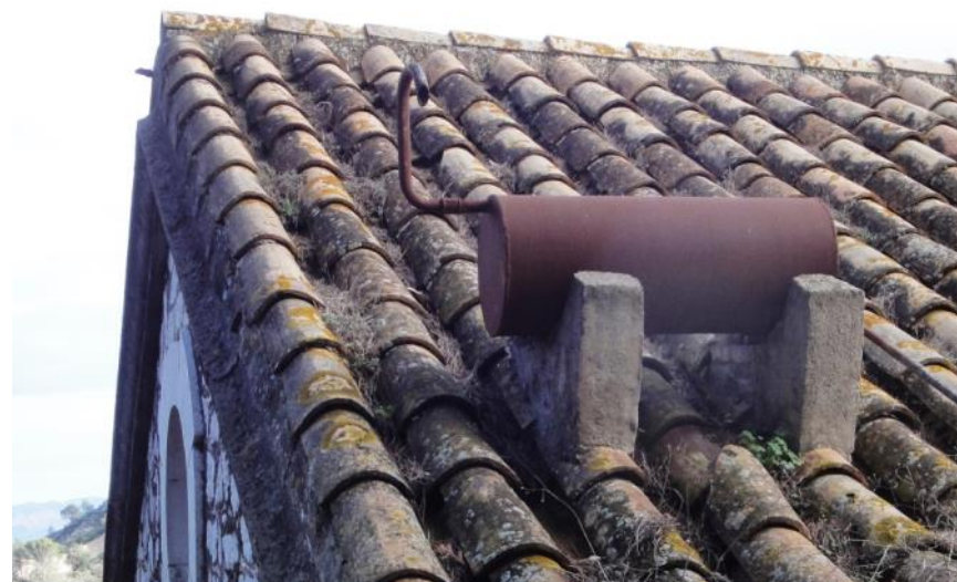
Img. 305: Elemento metálico oxidado sobre cubierta. Depósito de agua.
