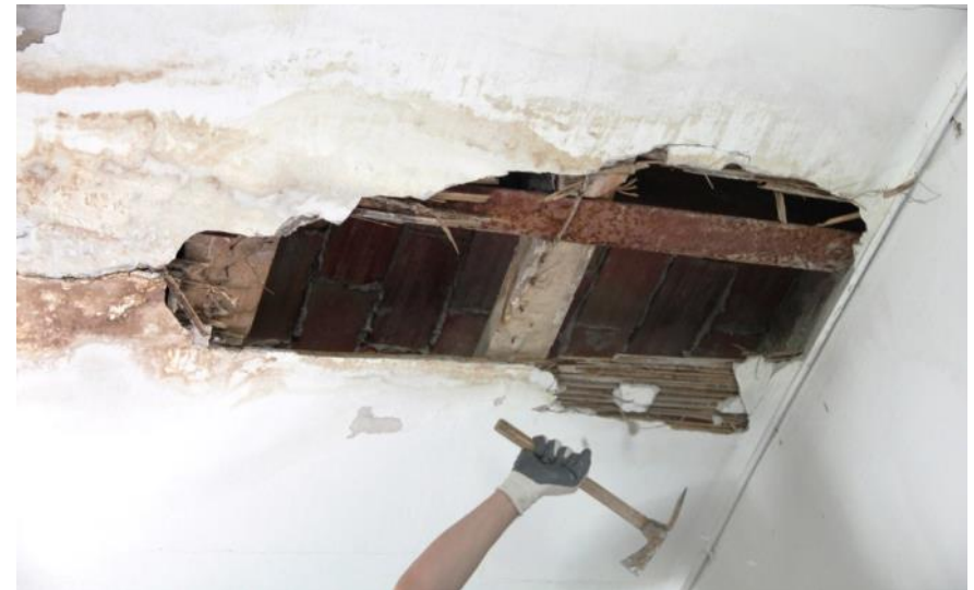
Img. 273: Cata del estado actual del falso techo de cañizo y yeso. Volumen añadido.
