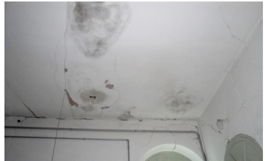
Img. 293: Infiltración cubierta plana. Lesiones en falso techo de cañizo.
