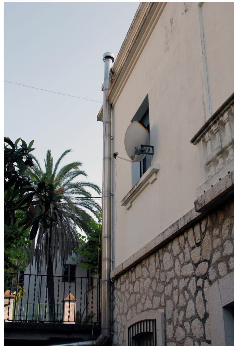
Img. 243: Elementos impropios. Chimenea de extracción y antena parabólica
