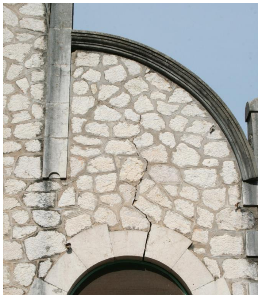
Img. 284: Grieta y rotura del arco. Asentamiento diferencial fachada principal.
