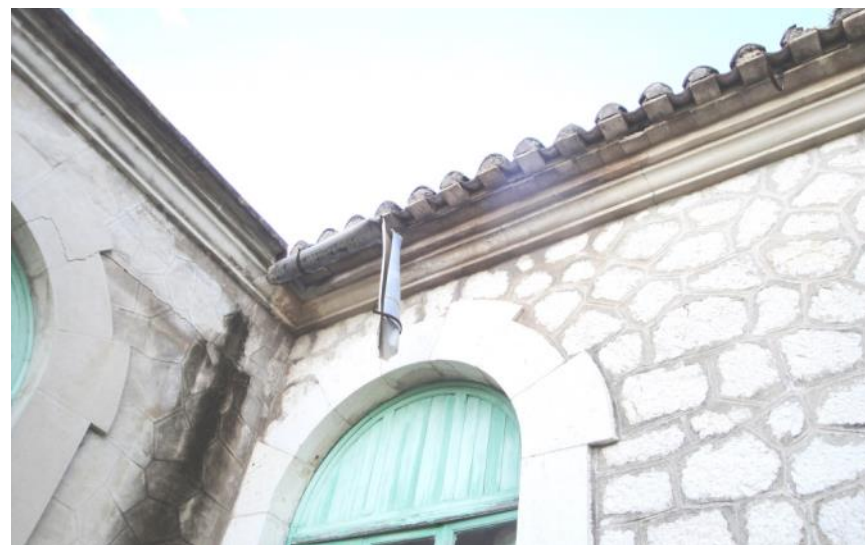
Img. 296: Rotura de canalón. Manchas por filtraciones y agentes bióticos.
