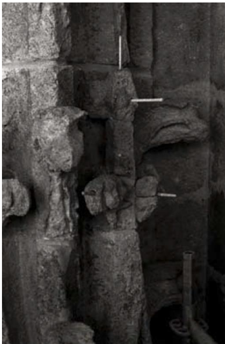
Figura 6. Inserción de varillas de fibra de vidrio con resina epoxi para anclar los fragmentos de piedra desprendidos. (Fotografía extraída de Proceso de intervención en las portadas del Nacimiento y del Bautismo de la Catedral de Sevilla 115 p).
