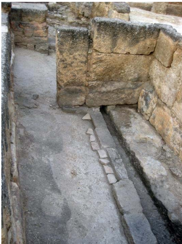
Ilustración 240. Conducto de evacuación a su paso bajo el recinto del depósito-cisterna.
