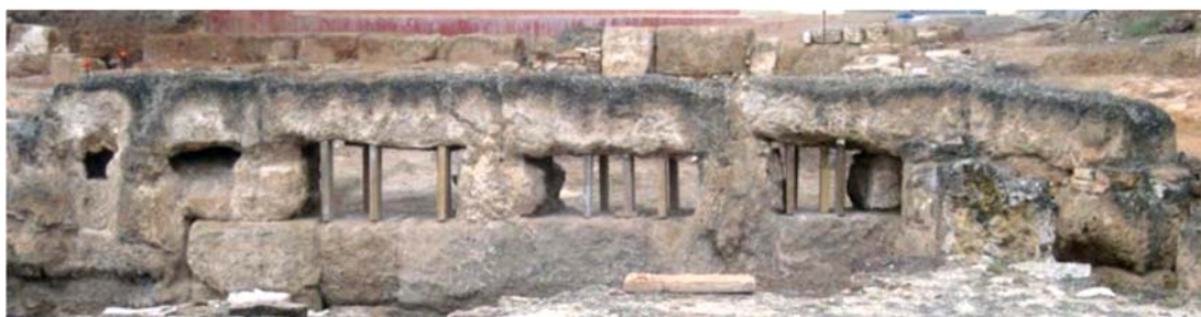
Ilustración 233. Conducción aérea. Tramo frente al ventanal del caldarium .
