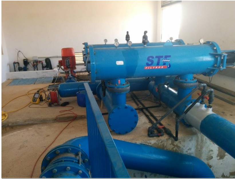
Figura 7. Sistema de filtrado
