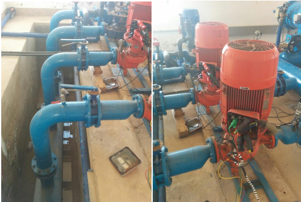
Figura 6. Sistema de bombeo
