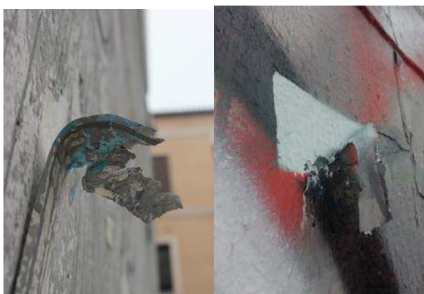
ILUSTRACIÓN. 6. Daños. Desahdesión en 2015 y 2017.
