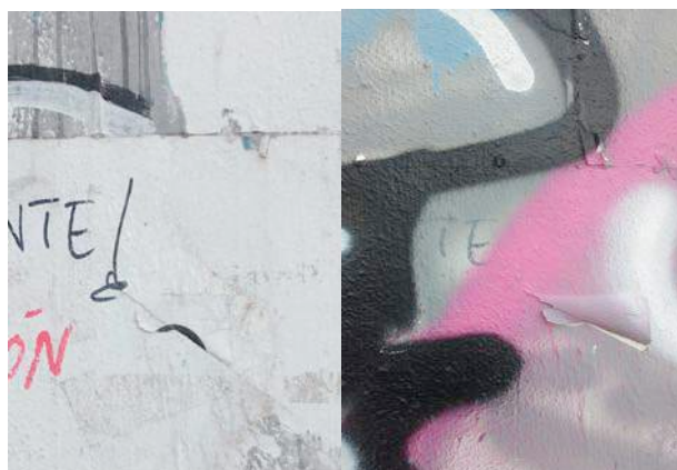
ILUSTRACIÓN. 7. Daños. Tag y graffiti en 2015 y 2017.
