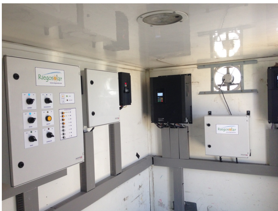
Figura 2: Cuadros de control y variadores de frecuencia
