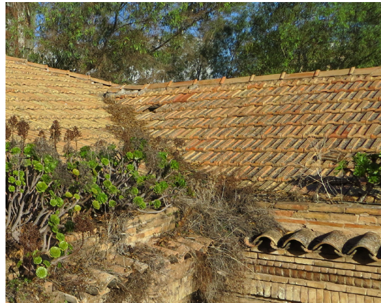
[Fig. 29] Imagen de cubierta anterior a la reparación. Cedida por Josef Pötter.
