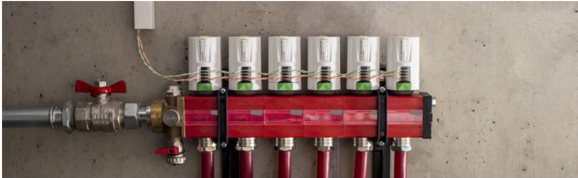
Figura 28. Actuadores válvula Tree instalados
