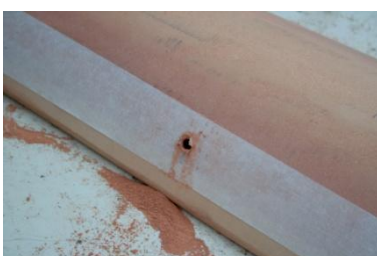
43. Perforación de una de las tejas
