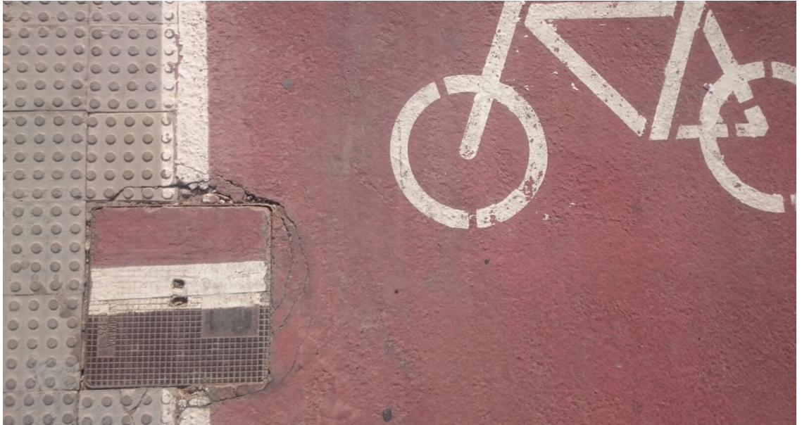
Alcantarilla recolocada del revés en un carril bici (fotografía personal)
