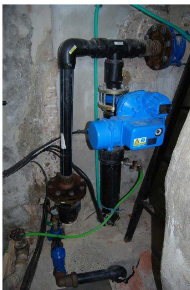
Foto 6.- Válvula motorizada EMG Topfmer
