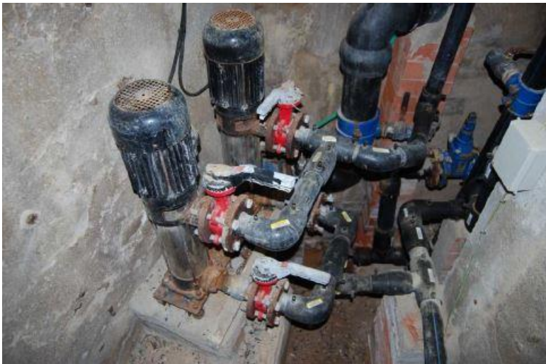
Foto 9.- Grupo de bombas de impulso.
