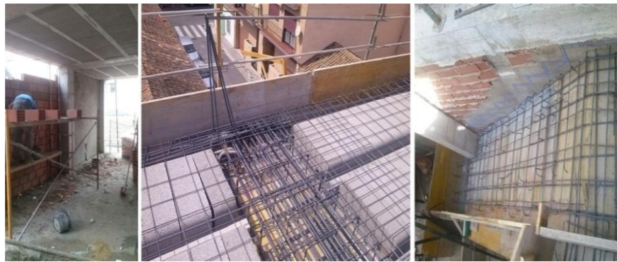
[FIG. 76]- SEXTA VISITA OBRA.CREACIÓN DE MURO DE MEDIANERA, Y COLOCACIÓN DE ARMADURAS EN VIGA, ZUNCHO Y ESCALERA DE PLANTA TERCERA . FUENTE: ELABORACIÓN PROPIA
