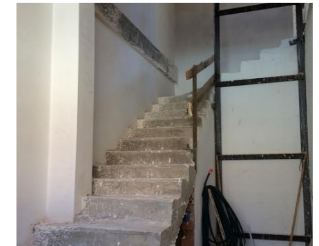
[Fig. 82]- SÉPTIMA VISITA OBRA. COLOCACIÓN CAPA DE ACABADO INTERIOR DE MORTERO DE YESO. FUENTE: ELABORACIÓN PROPIA
