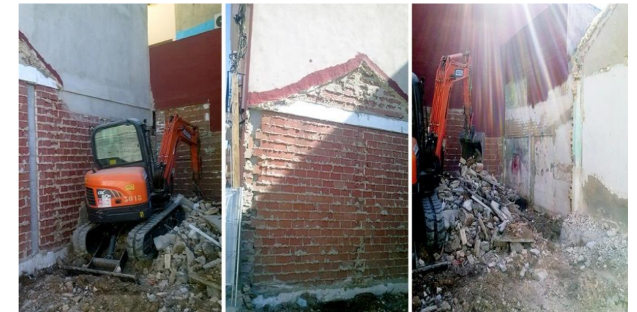
[FIG. 59]- SEGUNDA VISITA OBRA.DERRIBO CON RETROEXCAVADORA DE LA VIVIENDA PREEXISTENTE. FUENTE: ELABORACIÓN PROPIA
