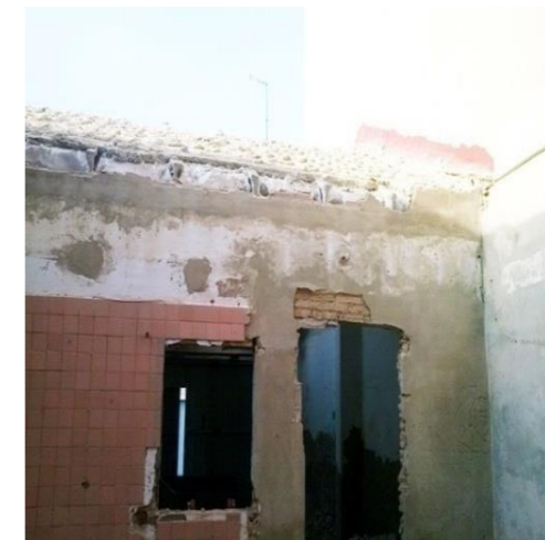
[FIG. 56]- PRIMERA VISITA OBRA. MORTERO DESPRENDIDO EN FACHADA VIVIENDA PREEXISTENTE. FUENTE: ELABORACIÓN PROPIA
