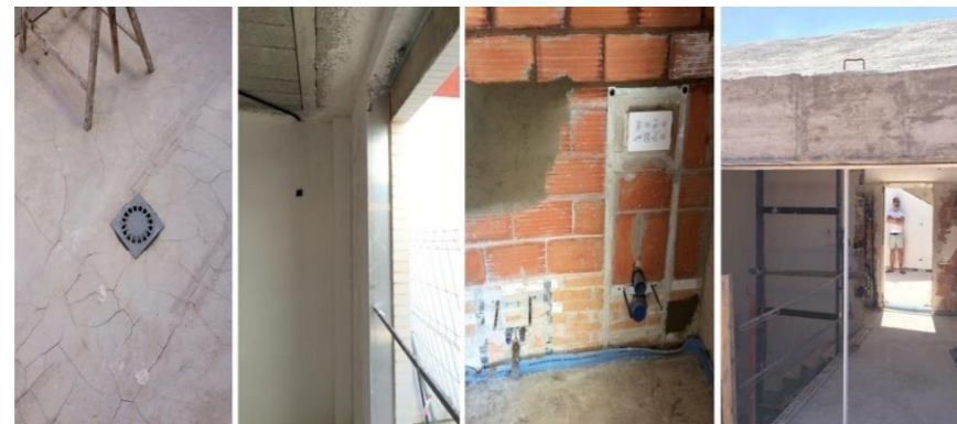
[Fig. 84]- SÉPTIMA VISITA OBRA. AGRIETAMIENTO MORTERO EN TERRAZA. COLOCACIÓN PREMARCO CARPINTERÍAS. DETALLES OBRA. FUENTE: ELABORACIÓN PROPIA
