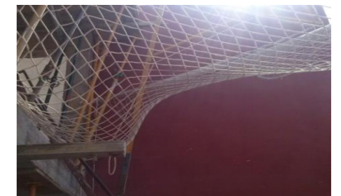
[FIG.72 ]- QUINTA VISITA OBRA.COLOCACIÓN DE RED DE SEGURIDAD PARA IMPEDIR CAIDA DE DESPRENDIMIENTOS. FUENTE: ELABORACIÓN PROPIA
