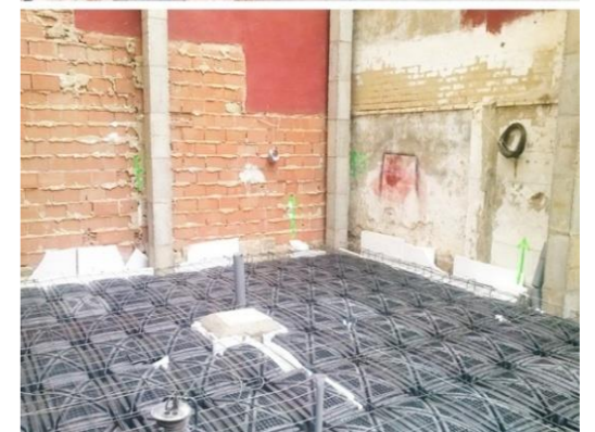
[FIG. 65]- CUARTA VISITA OBRA.CREACIÓN DEL FORADO DE PLANTA BAJA CON SISTEMA CAVITI. FUENTE: ELABORACIÓN PROPIA
