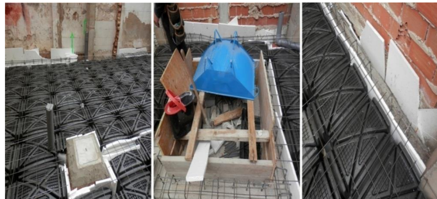
[Fig. 66]- CUARTA VISITA OBRA. CREACIÓN DE LAS ARQUETAS, HUECO DEL ASCENSOR Y SEPARACIÓN DEL HUECO PARA LA MEDIANERA. FUENTE: ELABORACIÓN PROPIA
