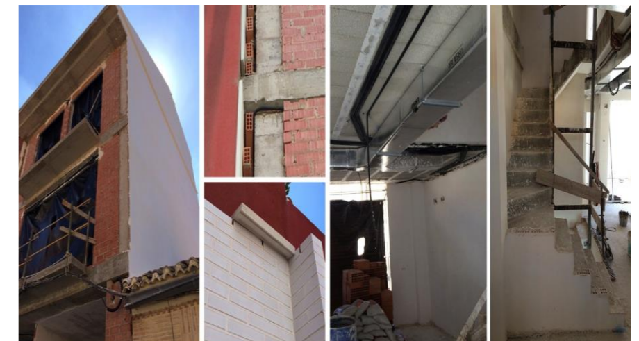
[Fig. 83]- SÉPTIMA VISITA OBRA. COLOCACIÓN CAPA DE MORTERO Blanco EN LA PARTE EXTERIOR DE LA MEDIANERA. INSTALACIÓN CLIMATIZACIÓN. DETALLES DE OBRA. FUENTE: ELABORACIÓN PROPIA
