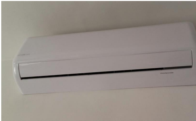
Figura 6-9: Aire acondicionado 2º infantil
