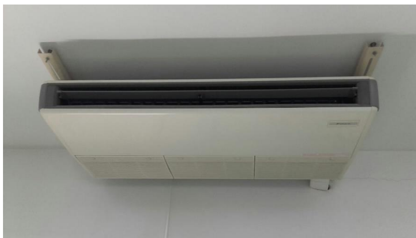
Figura 6-11: Aire acondicionado informática
