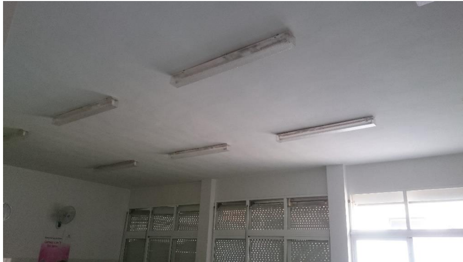
Figura 6-1: Tubos fluorescentes T8 de 150 cm en la zona comedor
