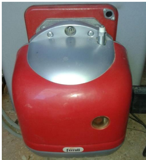
Figura 6-4: Quemador de la caldera de gasóleo
