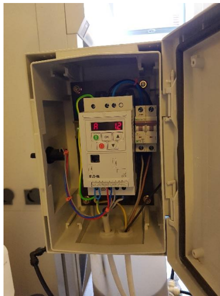
Figura 3.2.2.9 – Módulo electrónico de la planta de ultrafiltración de membrana cerámica
