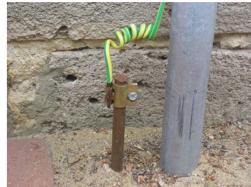
Imatge 26: Pica connexió a terra. Font: Google imatges
