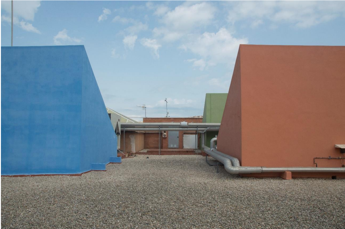
Ilustración 12: Estado actual tejado. Fuente: Elaboración propia
