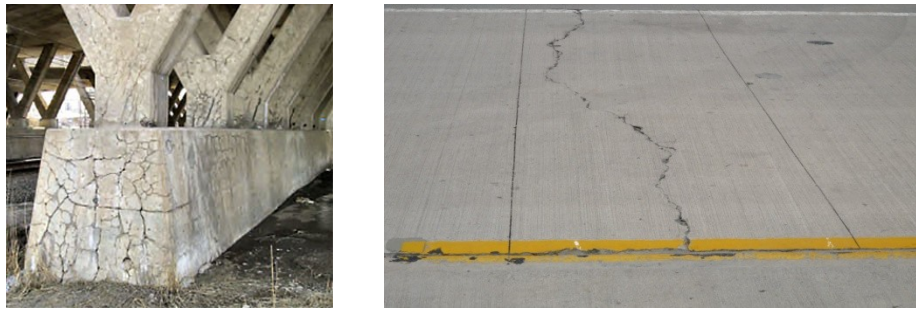
Figura 1.1. [Fisuras en obras de hormigón ocasionadas por diferente patología.]
