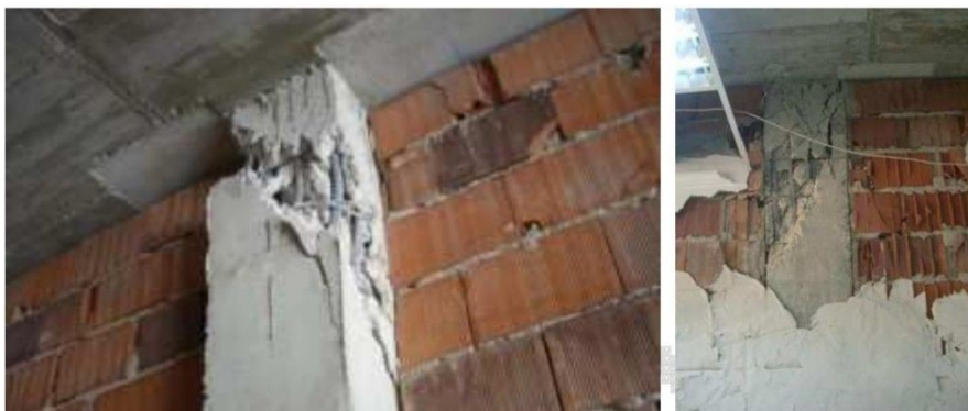
Figura 4.11 [(Izquierda) Rotura por cortante en cabeza pilar debido a biela de compresión por sismo. (Derecha) Rotura en cabeza de pilar por efecto de corte de la tabiquería (bielas diagonales) y tabique dañado.]
