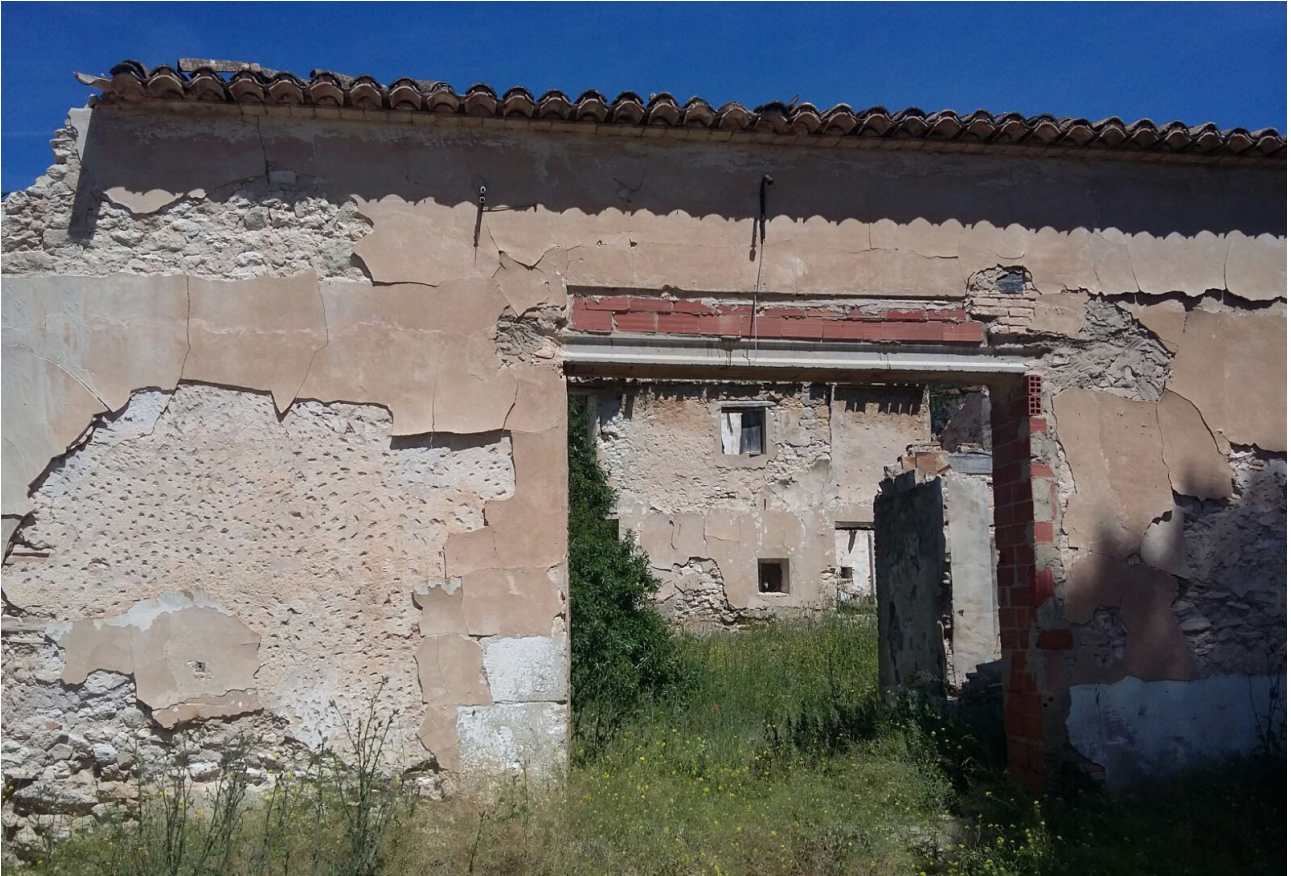
Imagen 47. Casa abandonada. Agullent. 2017
