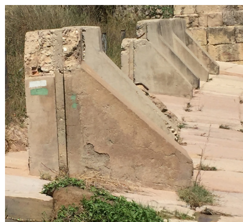
Fig. 26. Detalle de albarda con hendidura.
