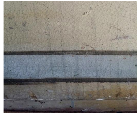
Fig. 45 Manchas de humedad
