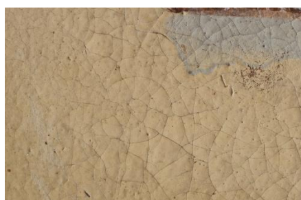
Fig. 40 Craqueladura por golpe
