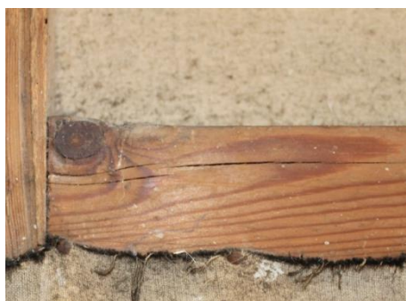
Fig. 28 Detalle del nudo y las grietas
