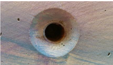
Fig. 30.: Detalle del mechinal.
