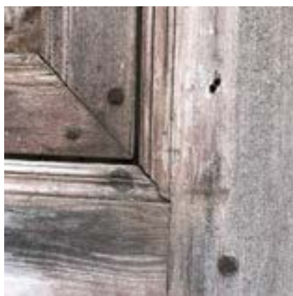
Figura 11. Fotografía marca de orificios de la cubierta.
