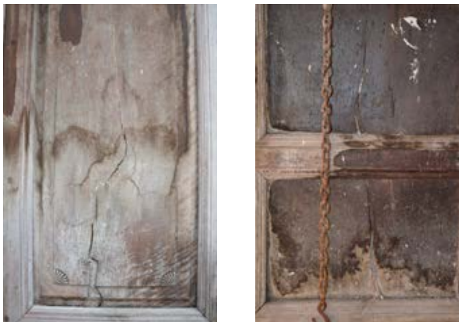
Figura 29. Grieta vista exterior y vista interior.
