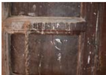
Figura 24. Fotografías de elemento añadido y manchas de pintura.
