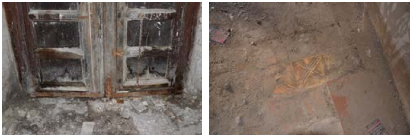
Figura 22. Fotografías del estado del suelo y algunas baldosas que se conservan.
